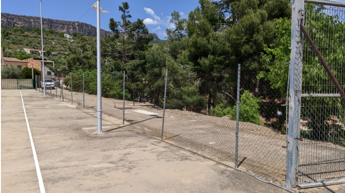
Vista general: lateral N-E amb forats en malla i pals desplomats
