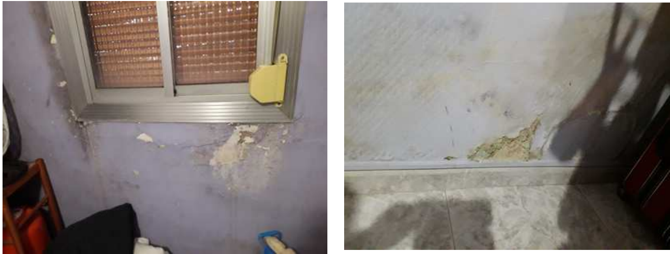
Imatge de fusteria al pati d'illa de la planta 1ª i humitats a la pared del cuarto de bany
