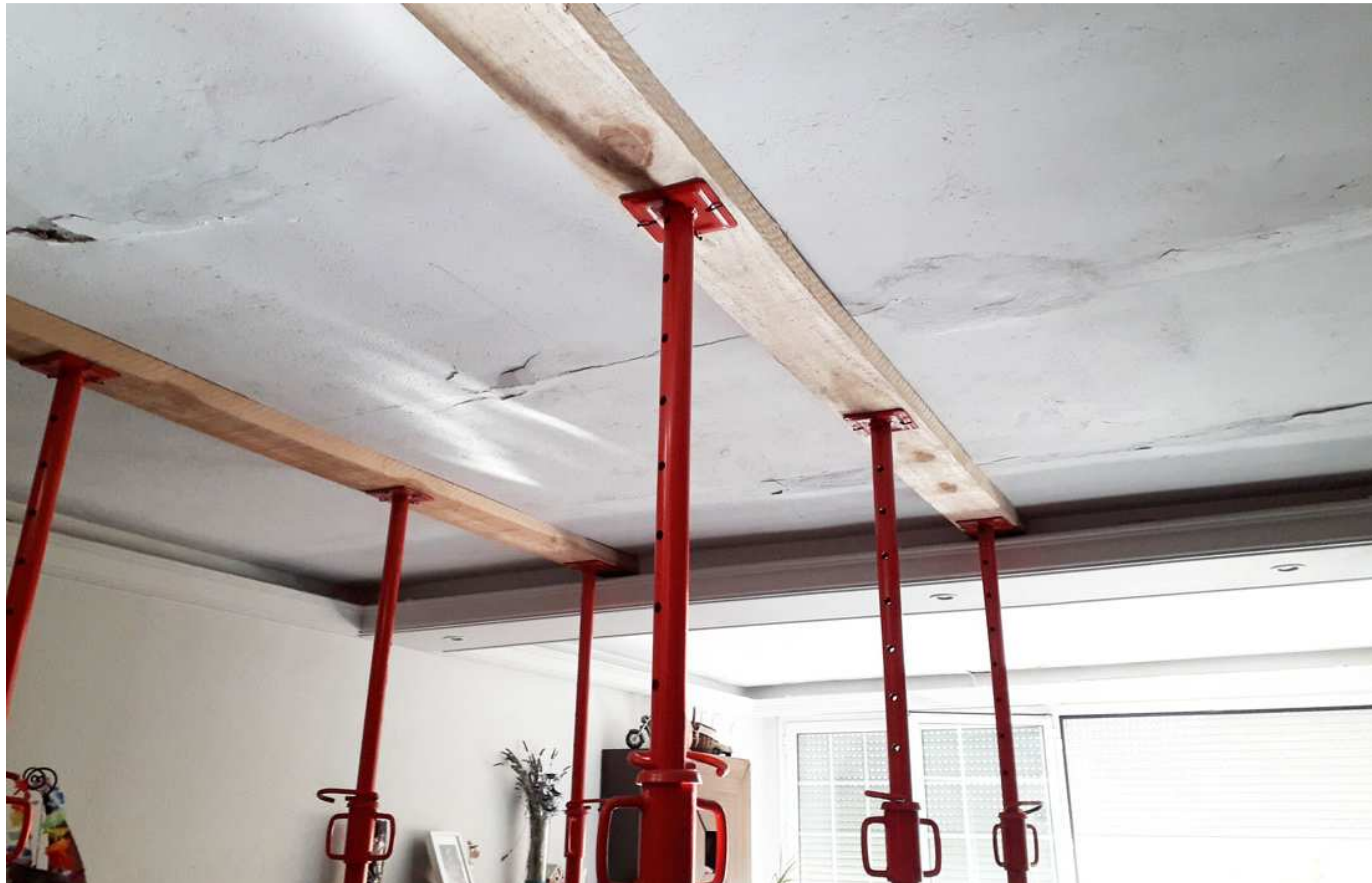
Fig-5 Mesures cautelars baix el forjat de coberta
