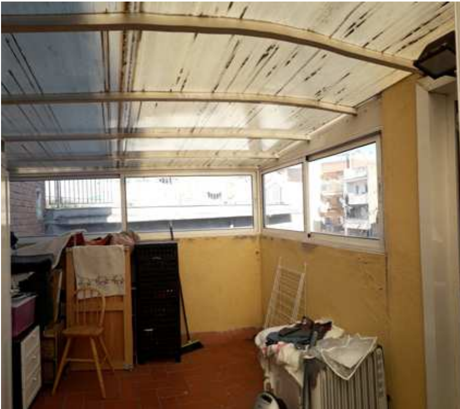
Imatges de cuina, estar-menjador apuntalat, detall de bigueta trencada i terrassa coberta amb polícarbonat
