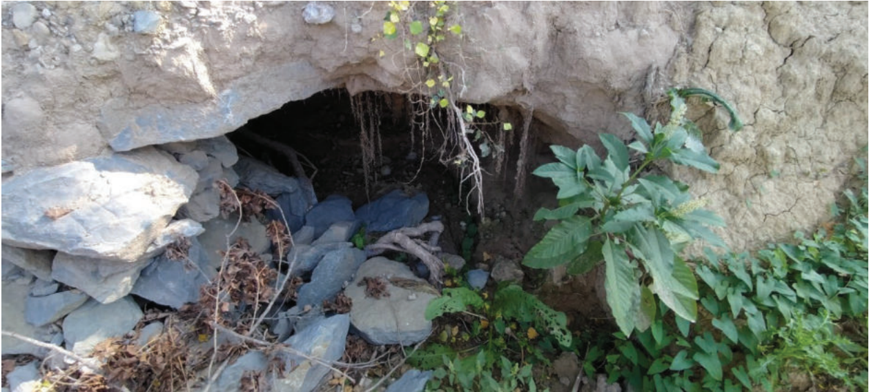
Figura 10 Detall d'un dels punts d'erosió més importants just abans del pas del canal per sota el camí
