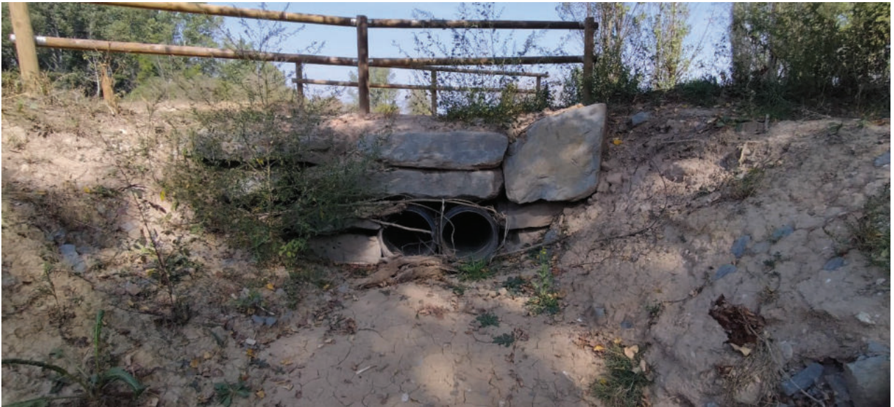
Figura 9 Vista del pas per sota la camí amb la presència de dos tubs que redueixen considerablement la secció hidràulica i on en moments d'actuació del canal de pluvials s'hi acumulen restes vegetals i sediment. La intercepció del cabal en aquest punt genera processos erosius aigües amunt.
