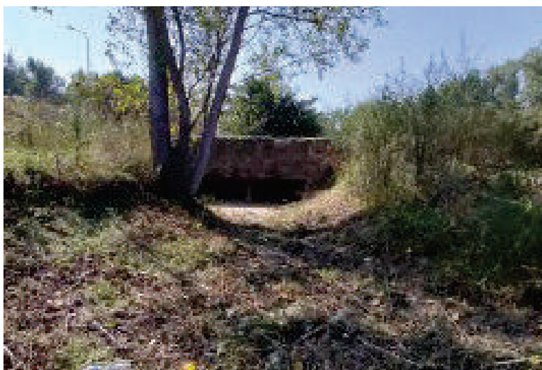
Figura 6 Sortida del col·lector de pluvials
