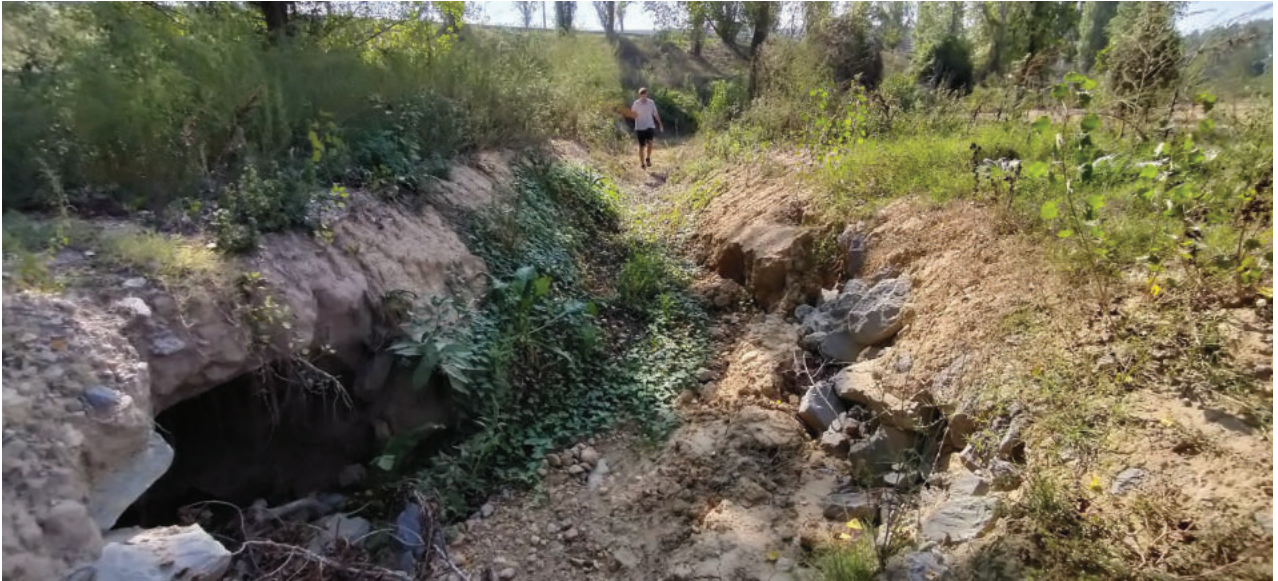
Figura 6 Tram de canal erosionat proper al creuament del camí
