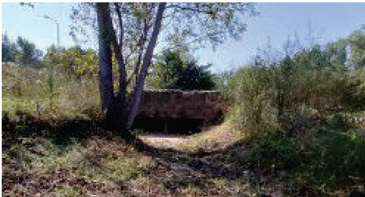
Figura 3 Sortida de pluvials i inici del canal
