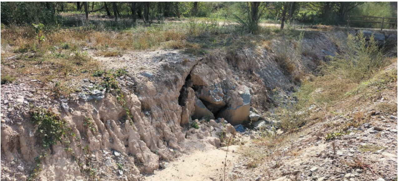
Figura 7 Talussos del canal erosionats.
