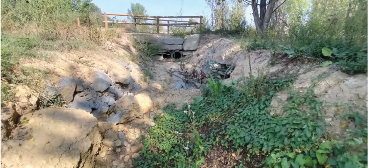
Figura 8 Tram de canal abans d'arribar al creuament amb el camí. Es poden observar punts d'erosió importants. Vista del pas per sota la camí amb la presència de dos tubs que redueixen considerablement la secció hidràulica.
