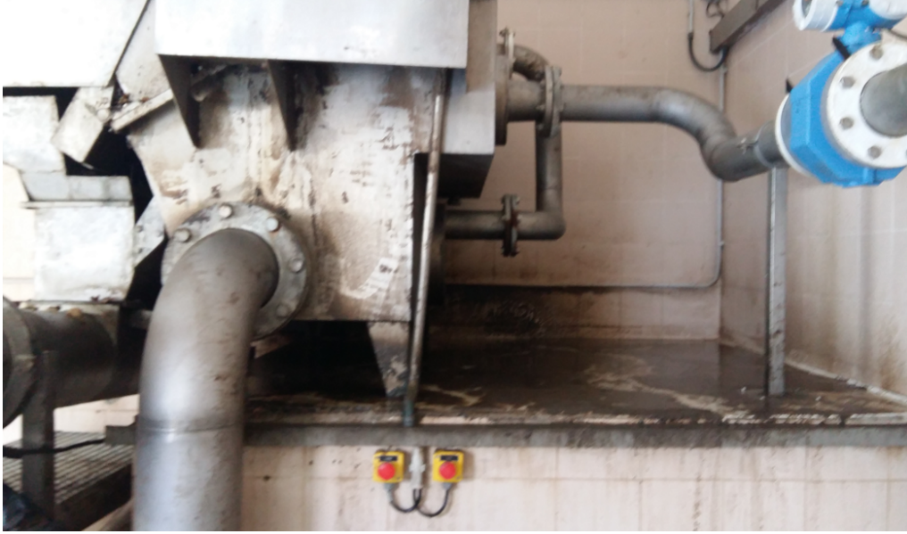
Figura 5. Detall de l'estat de l'estructura.
