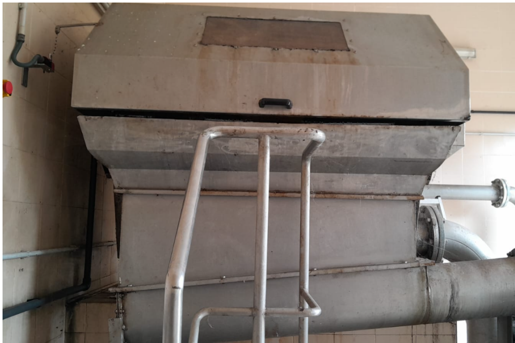
Figura 2. Tamís existent en el pretractament de l'EDAR.
