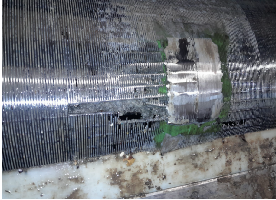
Figura 3. Detall de l'estat de la malla filtrant del tamís existent.
