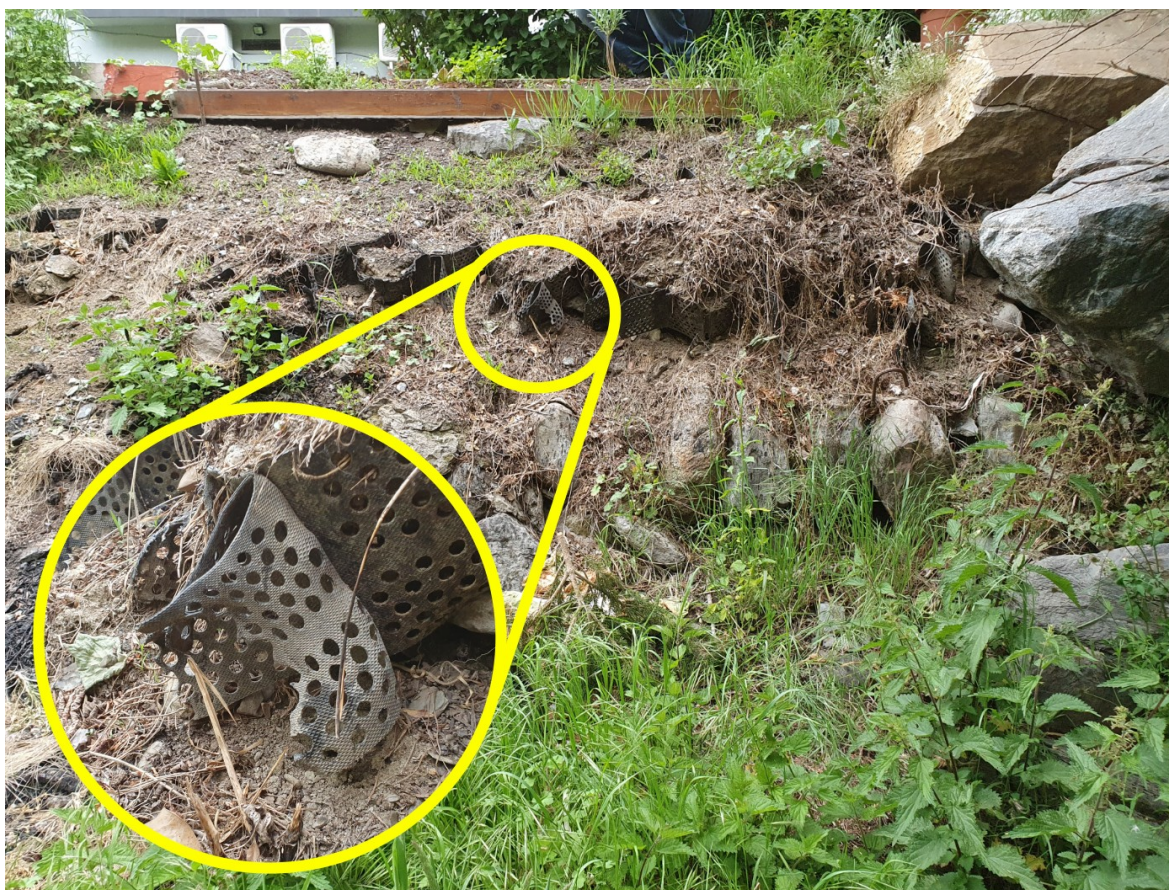
Trencament de l'estructura plàstica de suport de la cobertura vegetal
