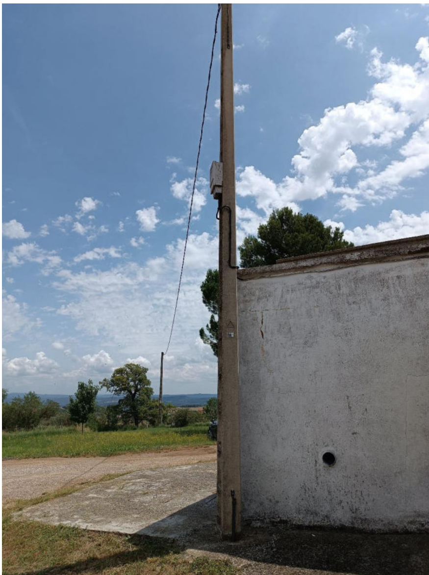
Fig. 5 Vista ubicació de l'escomesa amb CGP-7 i línia aèria del subministrament actual de l'emplaçament
