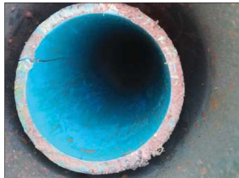
Fotografia 4. Boca de piezòmetre S3
