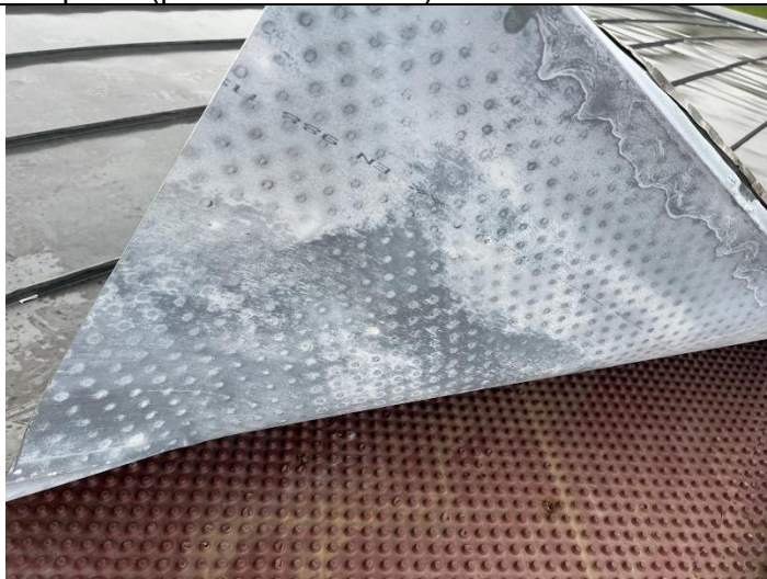
Detall de la planxa de zinc arrancada de la seva base de subjecció
