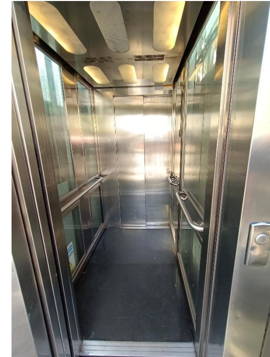
Imatge 7. Vista interior cabina ascensor
