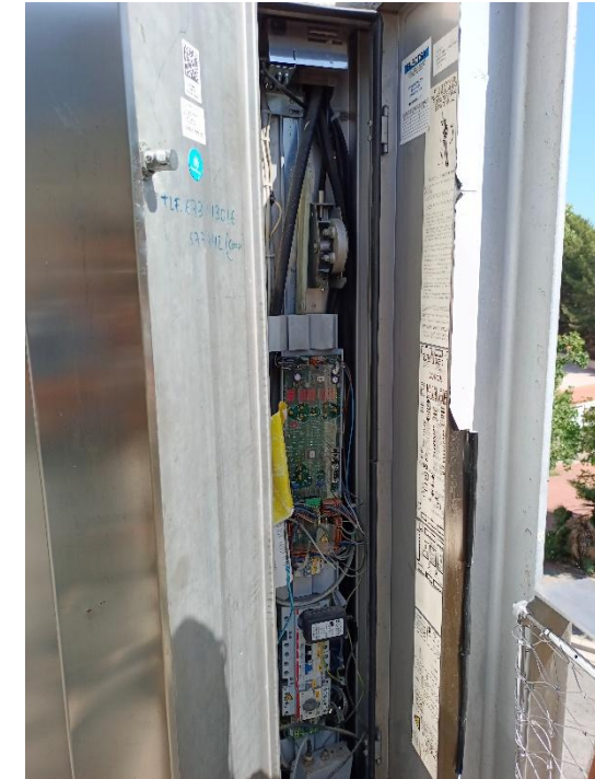
Imatge 9. Armari lateral d'instal·lacions ascensor
