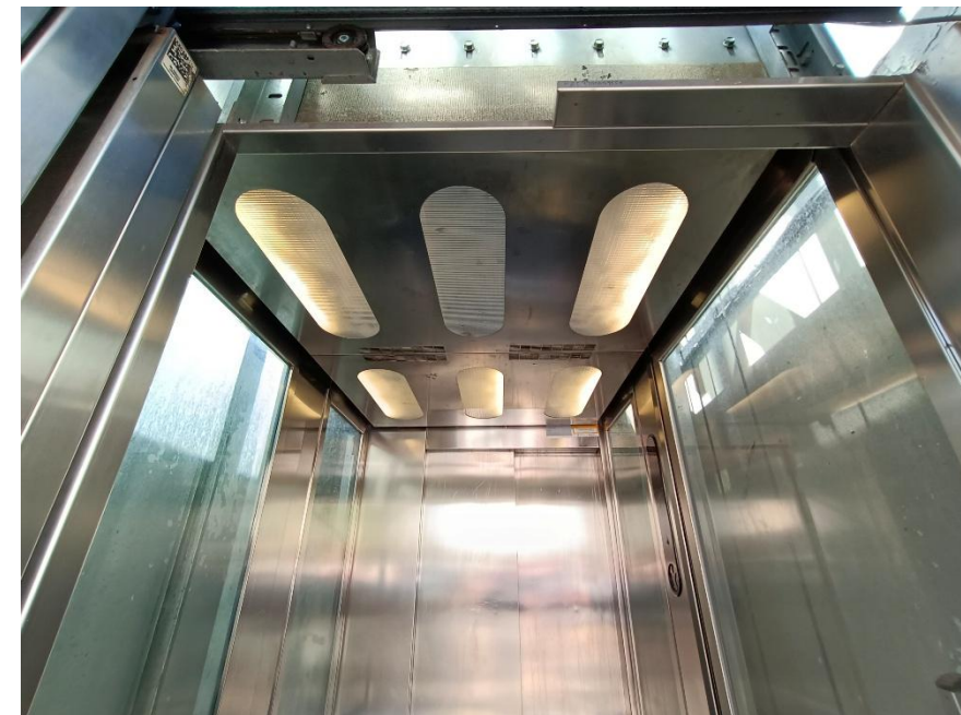
Imatge 11. Sostre cabina ascensor
