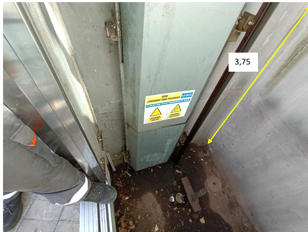
Imatge 1. Vista general del fossat d'ascensor, alçades platines de reforç
