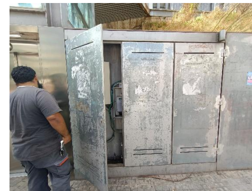
Imatge 10. Armari elèctric de l'ascensor
