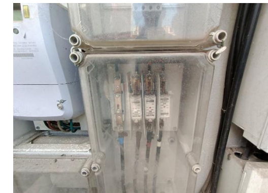
Imatge 11. Interior armari d'instal·lacions
