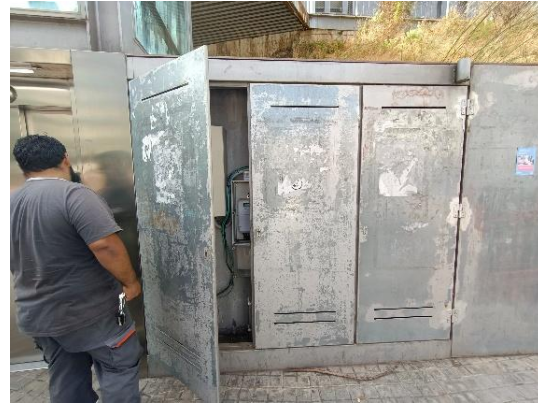
Imatge 9. Armari elèctric de l'ascensor
