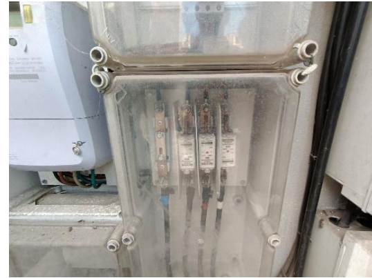
Imatge 10. Interior armari d'instal·lacions
