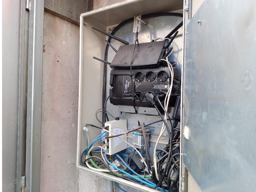
Imatge 8. Interior armari elèctric en nivell inferior (carrer Vallcivera)
