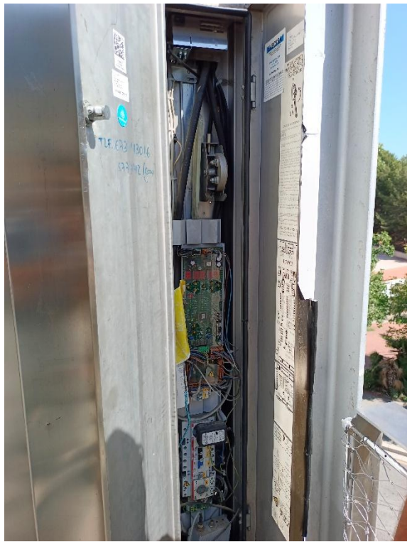
Imatge 13. Interior armari lateral en nivell superior
