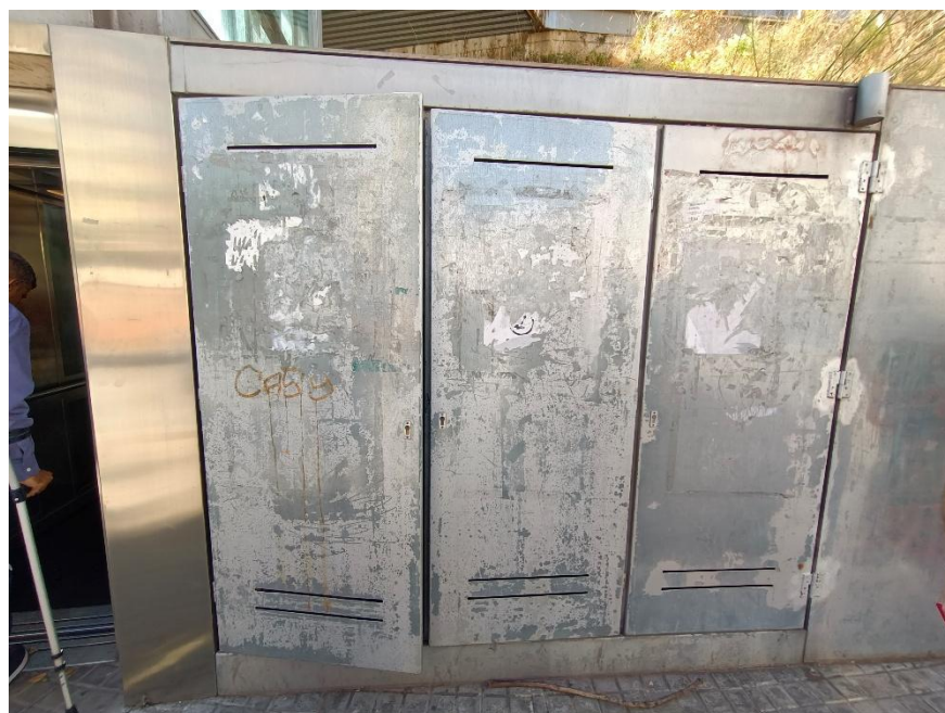
Imatge 5. Armari elèctric exterior en nivell inferior (Carrer Vallcivera)
