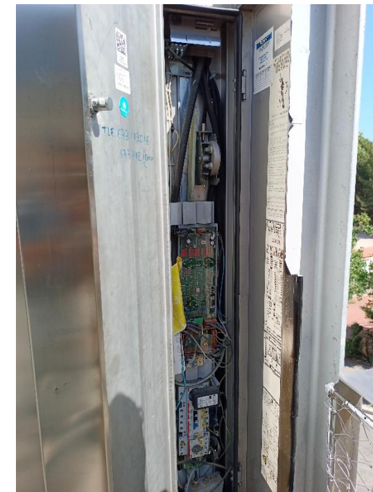
Imatge 8. Armari lateral d'instal·lacions ascensor
