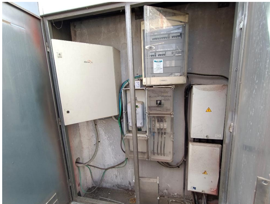
Imatge 9. Interior armari elèctric en nivell inferior (carrer Vallcivera)
