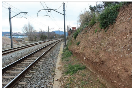
Foto n°2. Lleuger descalçament del tram inicial del talús.
