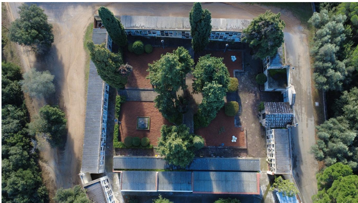
Estat general de les cobertes dels blocs de nínxols, part sud
