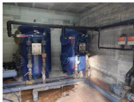
Procés de filtració
