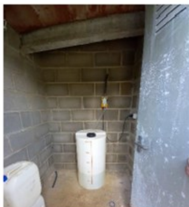
Emmagatzematge del clor
