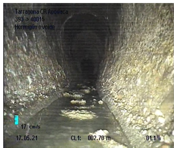
Foto 14. Despreniment de fragments d'estrep.
