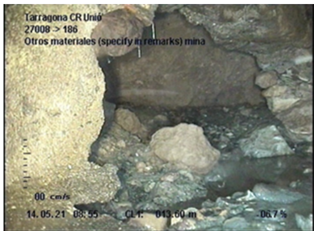
Foto 27. Dany amb greu soscavació de l'extradós.
