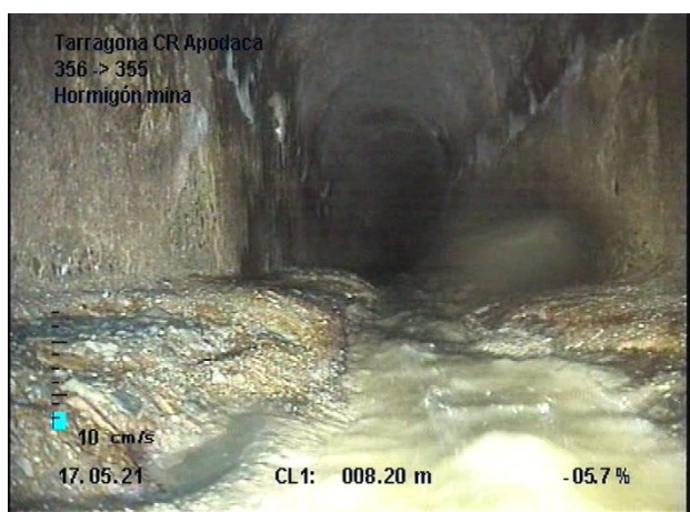
Foto 7. Solera amb molt desgast.
