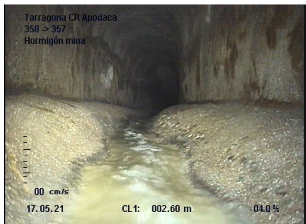
Foto 1. Solera amb molt desgast.
