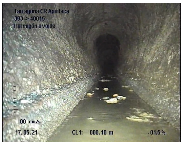
Foto 13. Erosió important de la solera i estrep.
