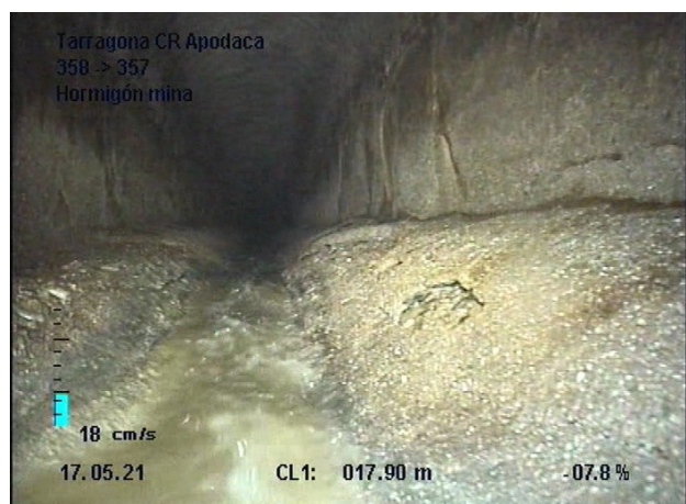
Foto 3. Solera amb molt desgast.
