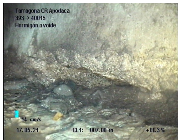
Foto 16. Detall de la pèrdua i soscavació de material
