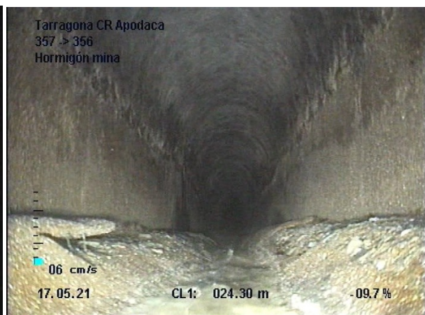
Foto 6. Trencadissa i pèrdua de la solera.
