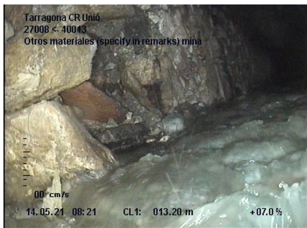
Foto 19. Tram amb l'estrep trencat
