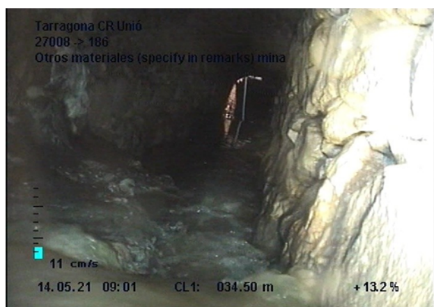
Foto 25. Estat d'erosió avançada de la solera.
