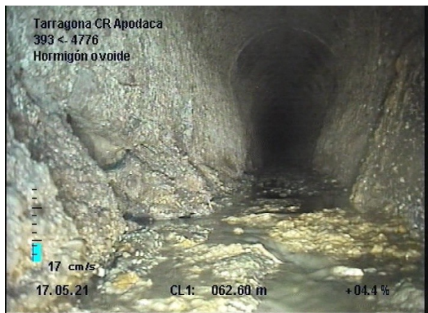
Foto 9. Pèrdues de material en els estreps.
