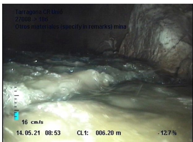
Foto 23. Ressalt hidràulica la solera per mal estat.
