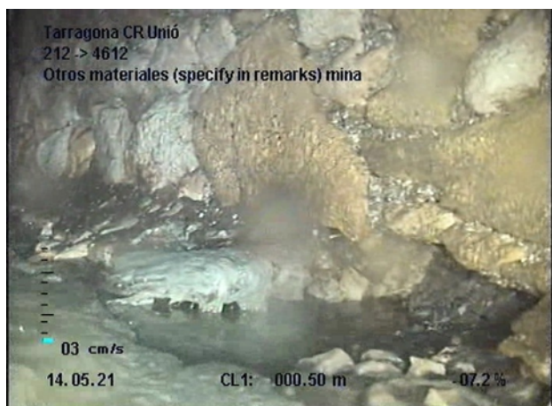
Foto 38. Soscavació gran en la solera i base estrep.
