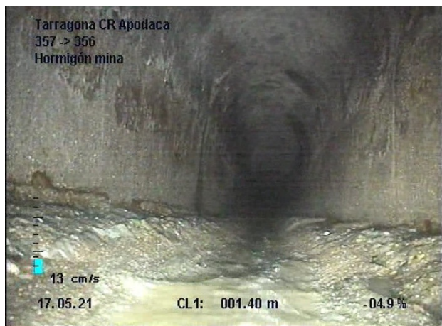
Foto 5. Solera amb molt desgast
