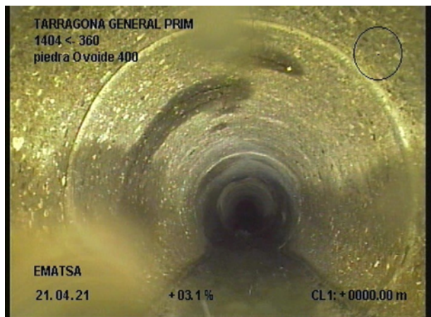
Foto 45. Esquerdes transversals en la clau del tub.
