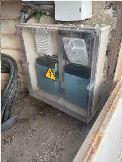
CAIXA SECCIONADORA Dreta
