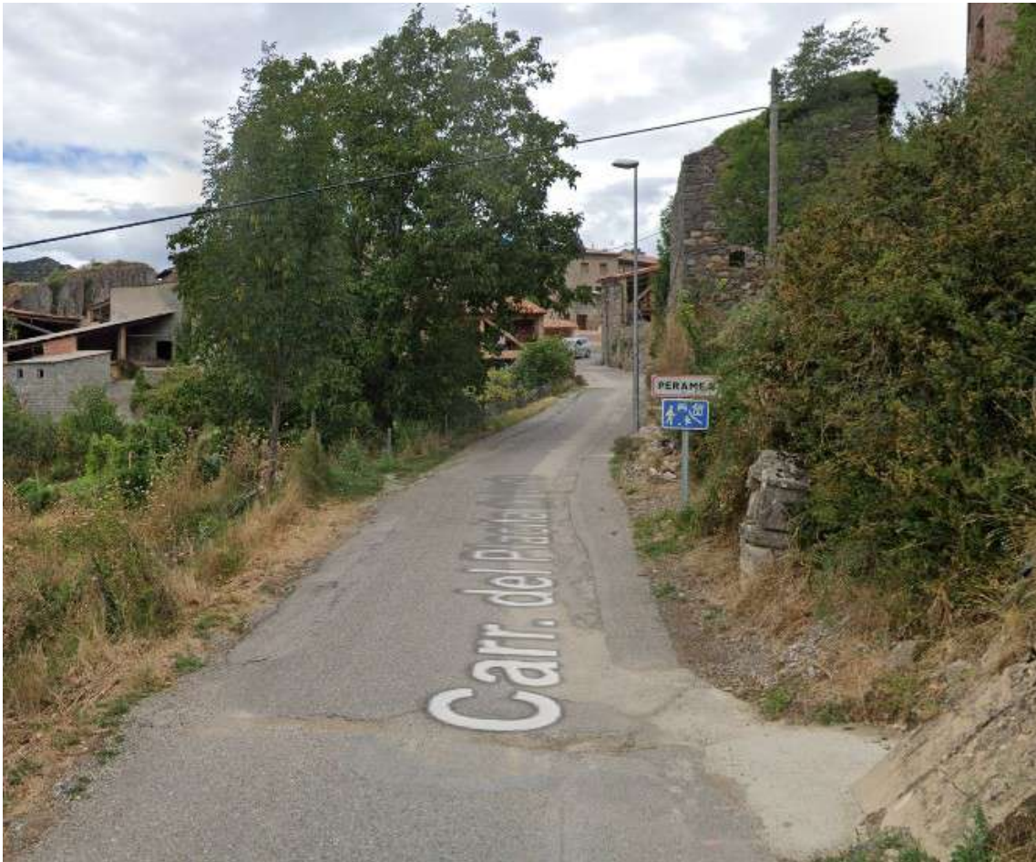
Imatge 10. Paviment a regularitzar
