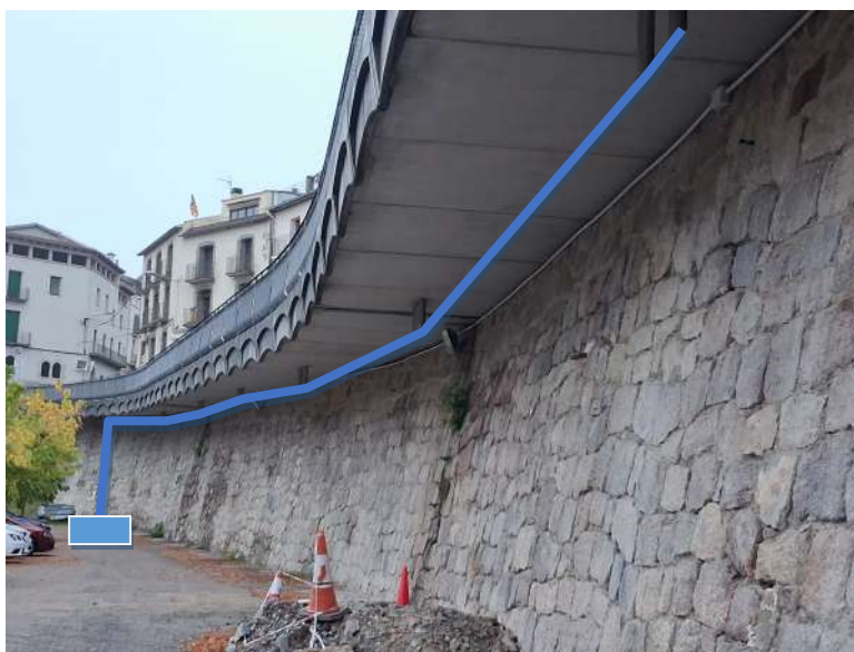
Imatge 9. Ramal de col·lecció de l'aigua pluvial per a reutilització.
