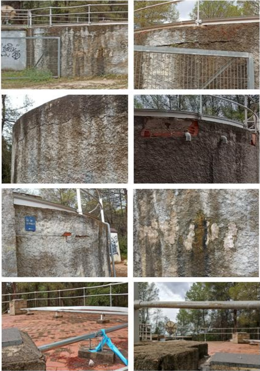
Figura 3. Patologies exteriors dels dipòsits de Can Trabal
