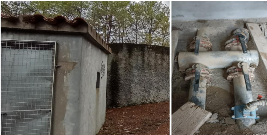
Figura 5. Caseta de vàlvules i canonades de sortida
