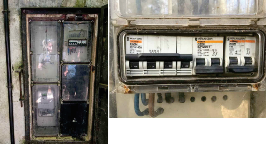
ARMARI ACTUAL DE L'ESCOMESA ELÈCTRICA DE CAN CASADES
