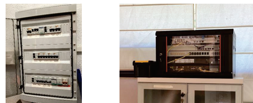
Figura 21. Quadre elèctric i rack de telecomunicacions existents del Centre d'Informació de Coll d'Estenalles
