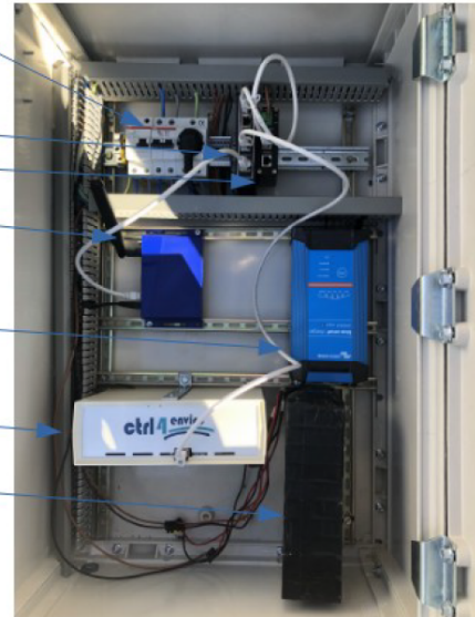
Imatge 1. Quadre amb els dispositius elèctrics i electrònics
