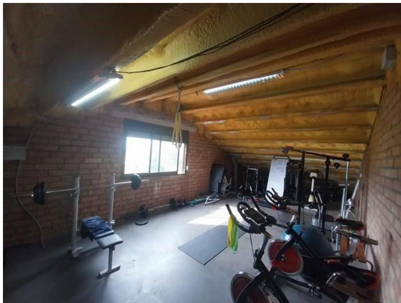
Fig.8: Façana no aïllada tèrmicament del gimnàs del Parc de Bombers de Puigcerdà.
