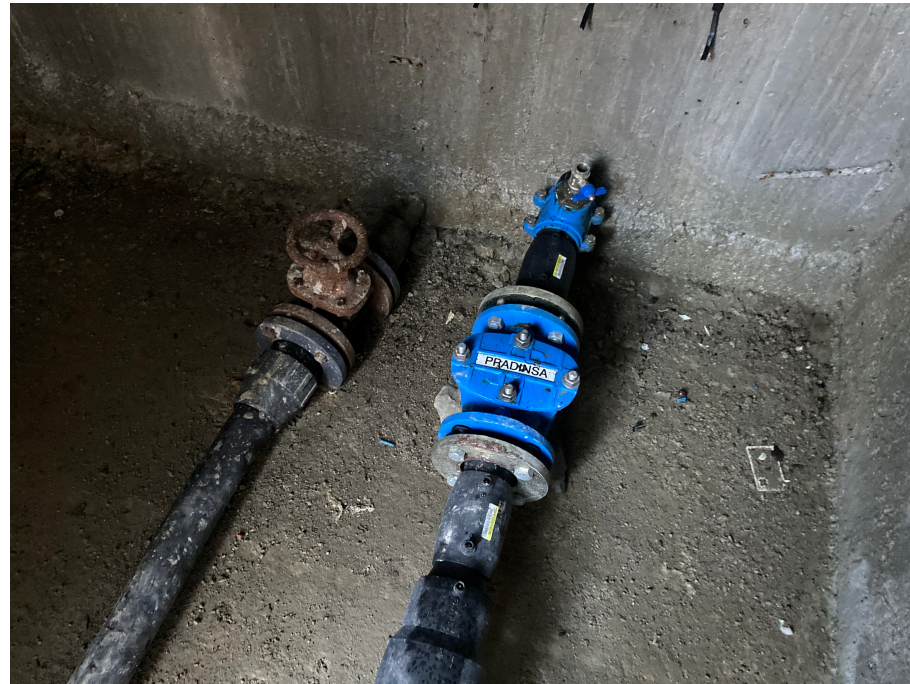
Foto 5 Detall de la canonada de sortida on hi ha la presa de l'aigua per a l'analitzador en continu i un filtre que encara donarà més pèrdua de càrrega en una instal·lació on el diàmetre de la canonada ja és insuficient.
