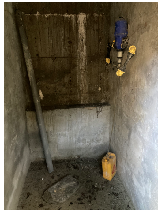
Foto 6 Detall de l'interior de la sala de cloració que es troba vandalitzada completament.
