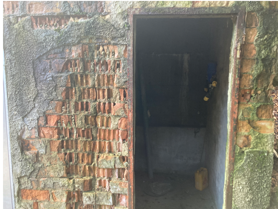
Foto 3 Vista de l'estat actual de la caseta amb les parets destruïdes per l'efecte del gel sobre els geros d'argila cuita, i les portes vandalitzades.
