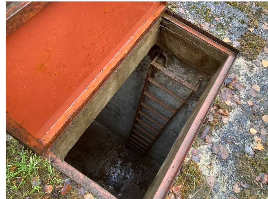
Foto 7 Detall de la tapa d'entrada al dipòsit que no està sobreelevada i de l'escala metàl·lica oxidable i sense sistema de protecció anticaigudes. Tampoc hi ha barana superior ni mecanisme d'ancoratge.
