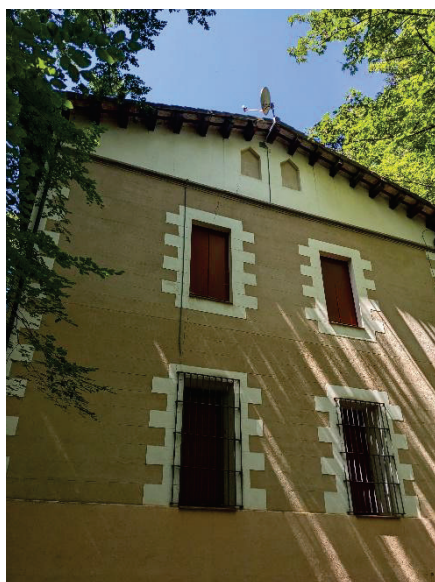
Figura 16. Emplaçament antena de telecomunicacions existent
