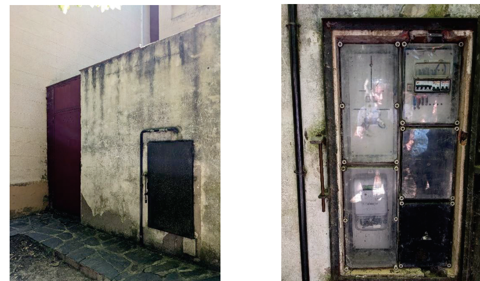
Figura 7. Emplaçament i detall de l'escomesa elèctrica del Centre d'Informació de Can Casades
