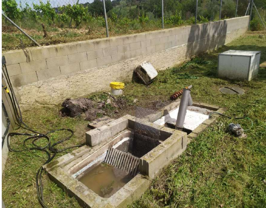
Foto 3: EDAR actual vista desbast de gruixuts i desbast de fins i tapa de la depuradora.
