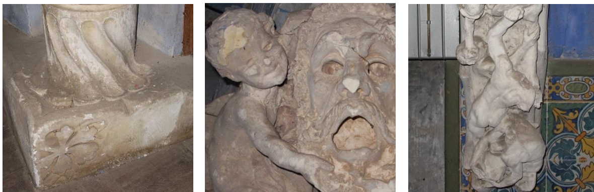
Desgasts superficials (G.13). Escantonats i desgasts (G.14). Dipòsits de pols i pèrdues de matèria (G.04.b).
