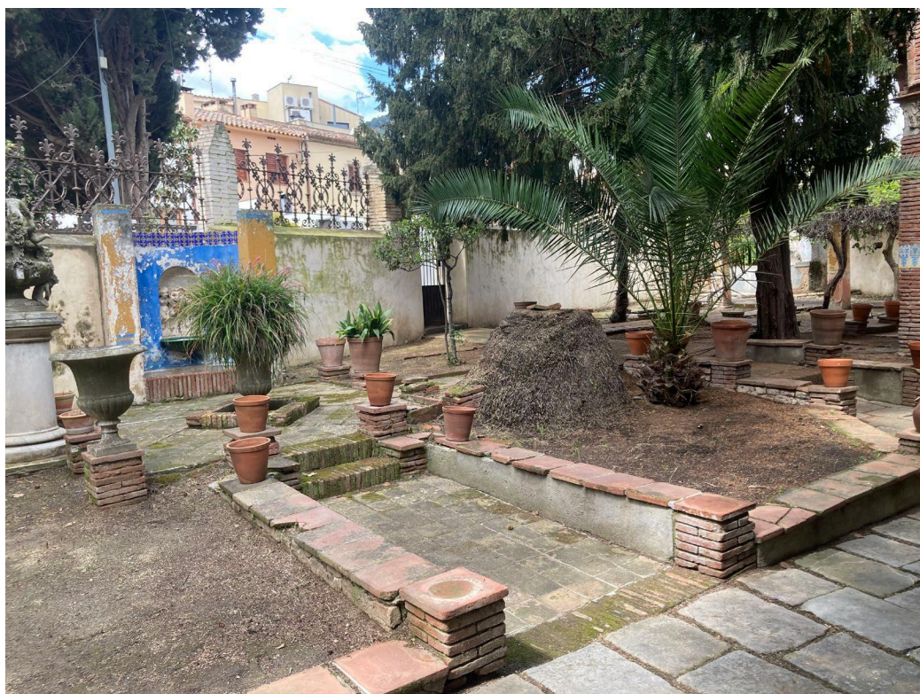
Imatge 19. Estat dels coronaments de murets.
