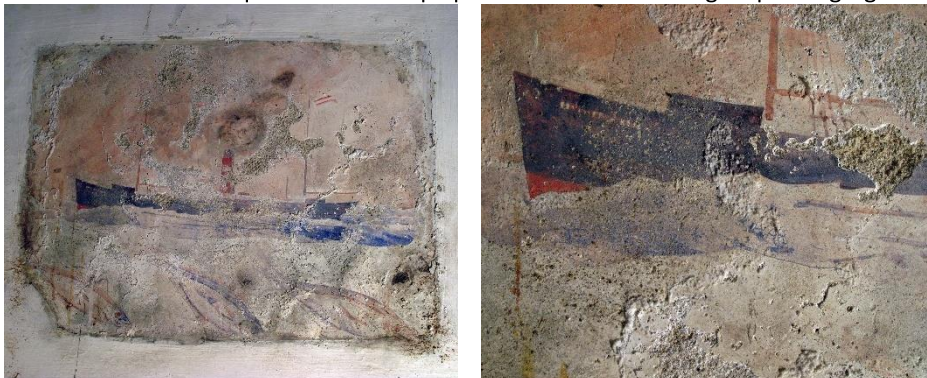
PM.03. Eflorescències salines, disgregació de la capa pictòrica i zones de pèrdua.
