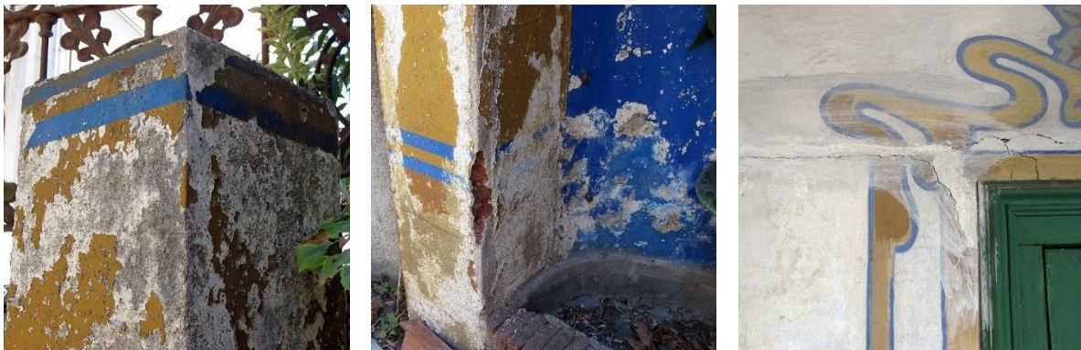
Brutícia, desgasts i pèrdues de pintura (PM.10). Esquerdes amb reparació (PM.12.a).
