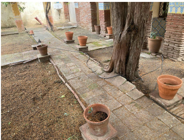
Imatge 16. Estat dels paviments
