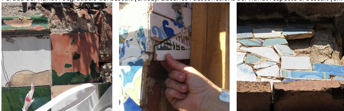
Pèrdua de rajoles i de la capa esmaltada (CR.20.a). Trencament i pèrdua de rajoles (trencadís xemeneies). Descohesió i bombament del revestiment en trencadís respecte el suport, i manca de morters de junta (CT.06).
