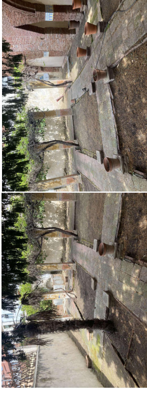
Afectació Yorades de Parterres i Paviment
