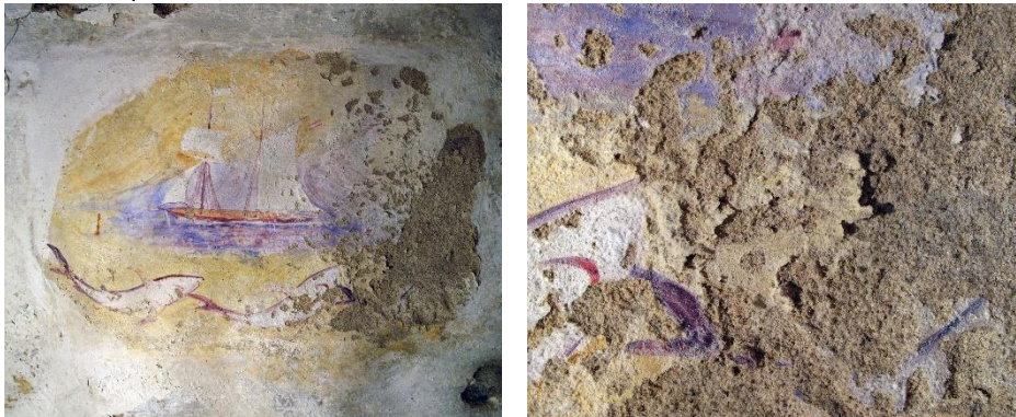
PM.02. Aixecaments i pèrdues de la capa pictòrica i del lliscat de guix per disgregació del morter.
