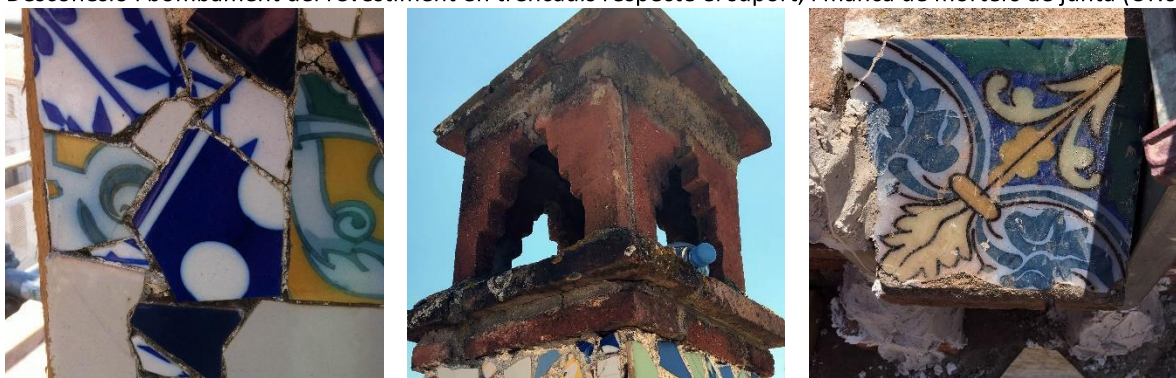
Rejuntat insuficient (CT.02). Reparacions diverses realitzades amb ciments (CT.01 i CR.01; R.48).
