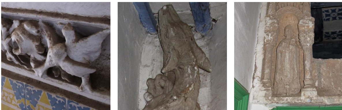
Dipòsits de pols (G.01). Disgregacions puntuals i desgasts superficials (G.07 i G.09).
