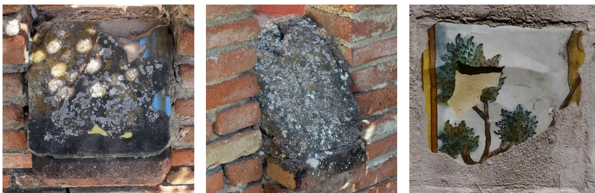
Pèrdua del vidriat i degradació del bescuit (CR.02). Llacunes i descohesions del vidriat respecte el bescuit (CR.42).
