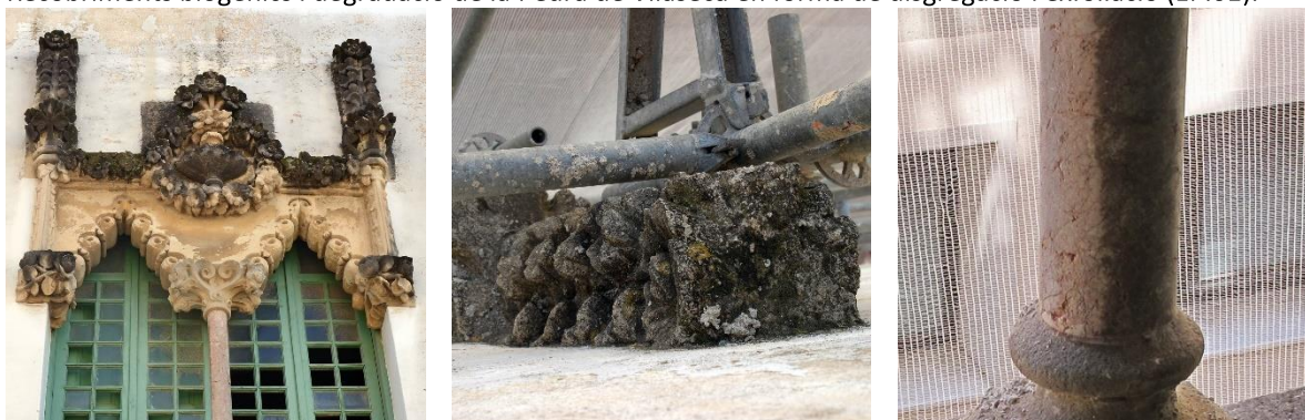
Recobriments biogènics i pàtina artificial (Pedra de Vilaseca, EP.05). Brutícia i fissures a la Bretxa del fust (EP.05).
