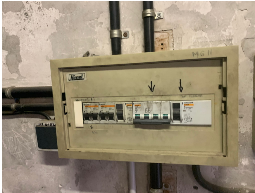
Quadre elèctric de la sala de màquines
