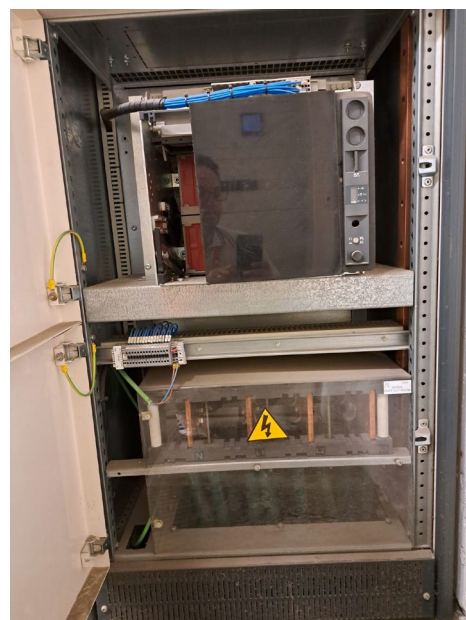
Okken 1_entrada grup_interior
