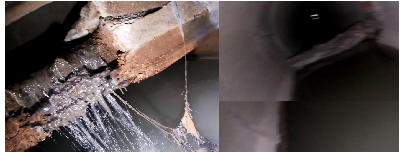
Fig. 7.16. B_035. a) abocament del sanejament en baixa al col·lector en alta, que creua per sota. Si la línia piezomètrica puja, el flux s'inverteix i el col·lector acaba alleujant per aquest orifici b) sanejament en baixa, i muret que força l'entrada de cabals residuals cap al col·lector en alta. Al fons, sortida al torrent de VX_013, a la fi del Carrer Olot
