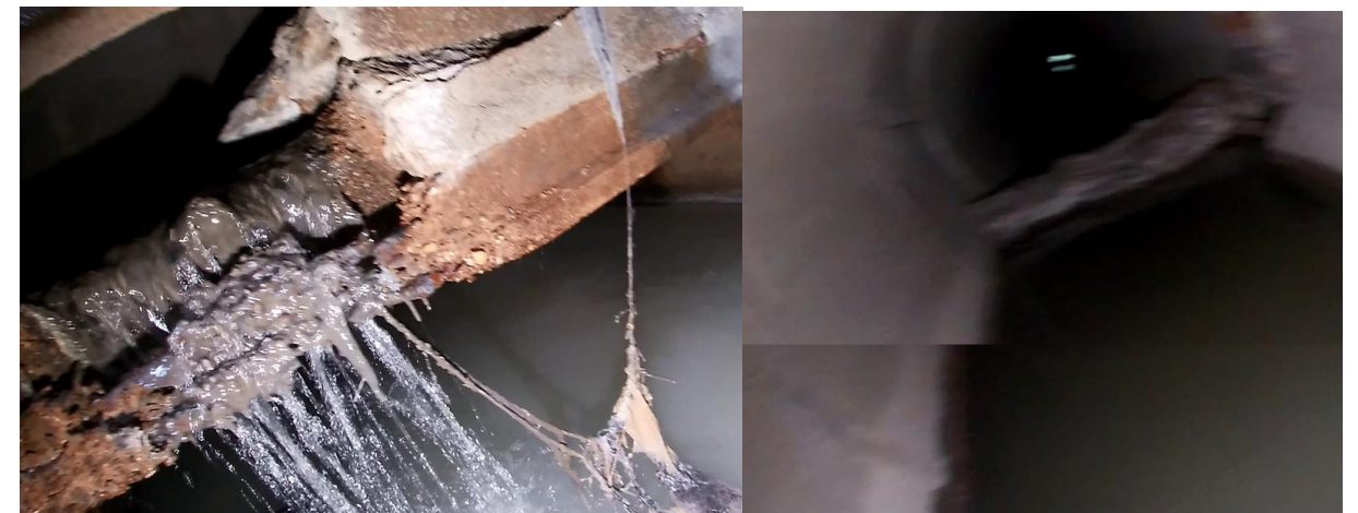
Fig. 4.7. B_035. a) abocament del sanejament en baixa al col·lector en alta, que creua per sota. Si la línia piezomètrica puja, el col·lector acaba alleujant per aquest orifici. b) sanejament en baixa, i muret que força l'entrada de cabals residuals cap al col·lector en alta que creua per sota i fa de llavi de sobreeximent. Al fons sortida al torrent de VX_013.
