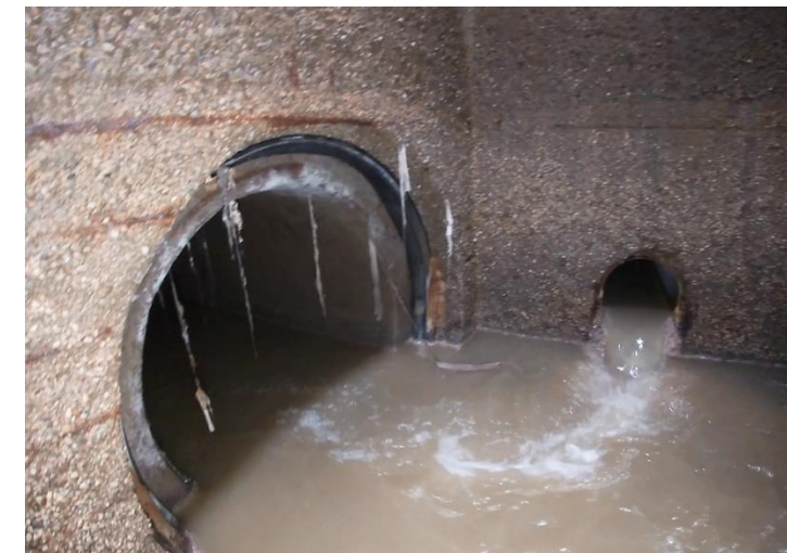
Fig. 3.17: a) Vòrtex VX_008, connexió al col·lector.
