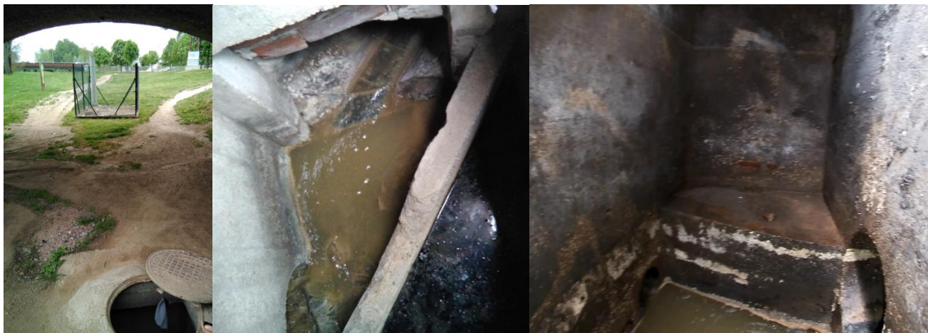
Fig. 3.12 a), b) Pou amb sobreeixidor VX_005a_S.c) "Vòrtex" VX_005, amb el sobreeixidor anul·lat.
