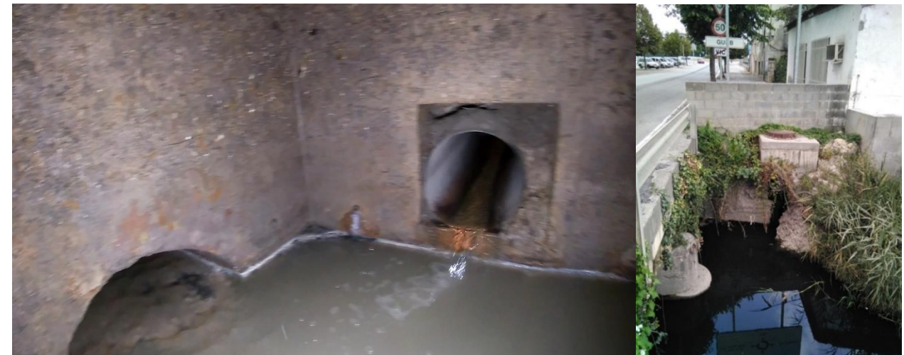
Fig. 4.11 a) Pou E_008, ja fora de la llera del torrent, en molt millor estat. b) Pou i sobreeixidor E_001a Aigües al torrent en temps sec de color molt fosc i amb despreniment de bombolles de gas. Presència d'abocament residual.
