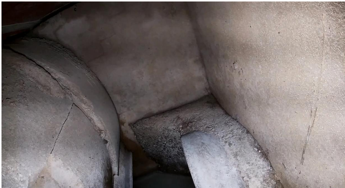
Fig. 4.6. B_035_S. Tub \phi 1500 en baixa (esquerra de la foto) creua per sobre del col·lector (dreta de la foto) i fa parcialment de "tap". Clavilles al tub de formigó \phi 1500
