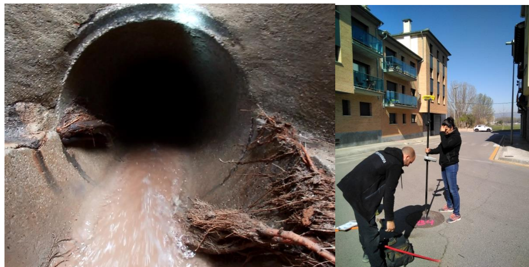
Fig. 3.5 Entrada d'arrels en alguns pous en el primer tram; b) Col·lector travessant nucli urbà de Calldetenes.
