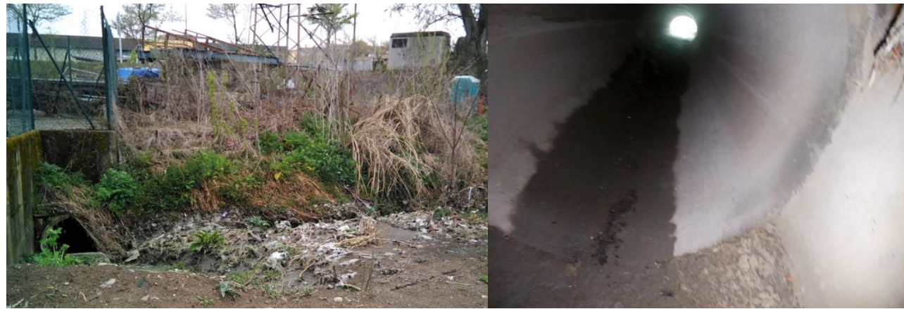
Fig. 8.7: Sortida sobreeixidor VX_008_S (esquerra). Sortida sobreeixidor VX_009_S (dreta)
