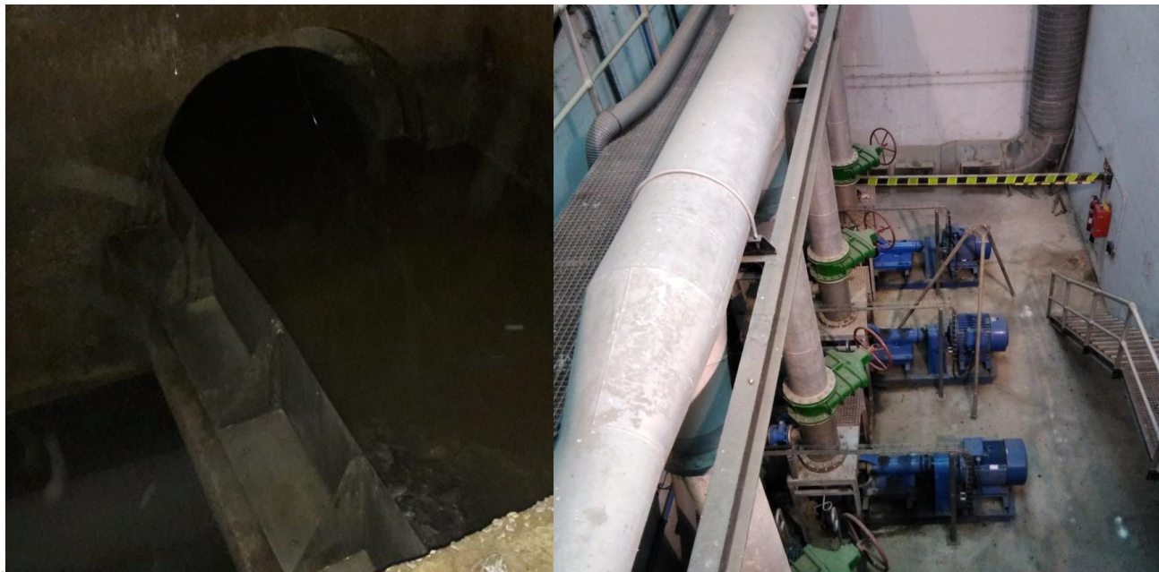
Fig. 3.18: a) Sobreexidor del bombament EB1. B) cambra de bombes de l'EB1.
