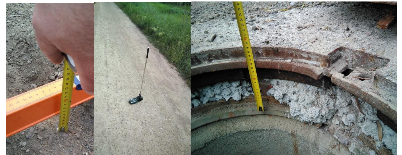
Fig. 3.6 Cobriment de les trapes del col·lector. a) capa de tot-u densa i de gairebé 10 cm de gruix. b) detector de metalls per a localització de les trapes. c) Recrescut de trapa C_063 en gairebé 20 cm per fer-la registrable.
