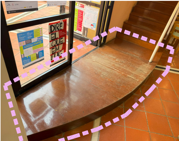
TARIMA DE FUSTA A SUBSTITUIR PER OBRA
