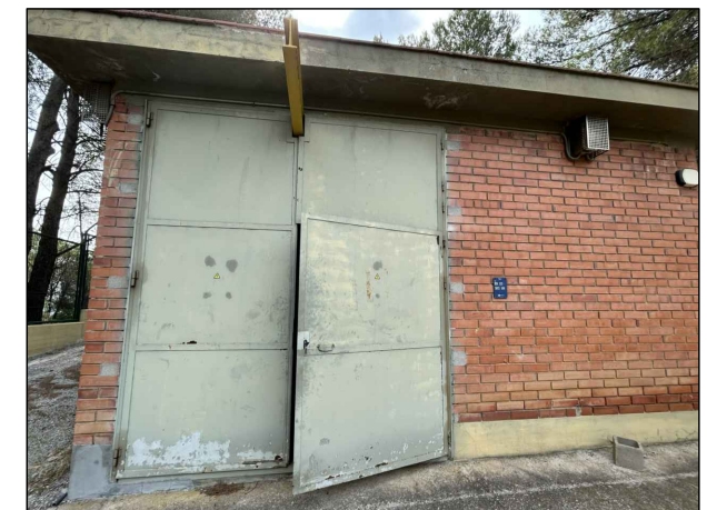
Caseta Vàlvules E6-03
