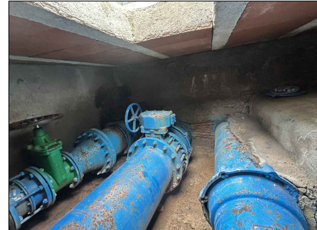
Interior arqueta entrada E6-51
