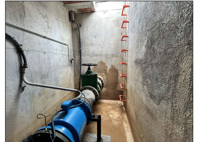
Interior arqueta cabalímetre E7-1A
