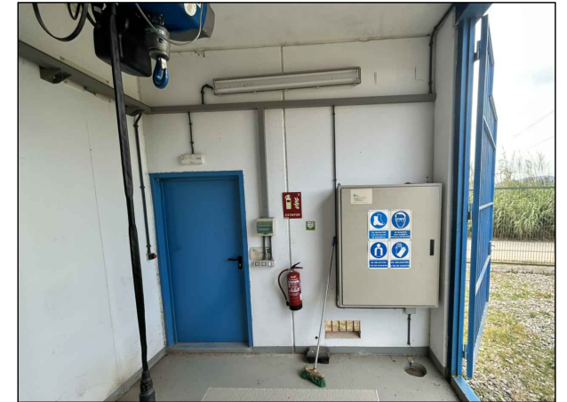
Interior de caseta de vàlvules F6-36
