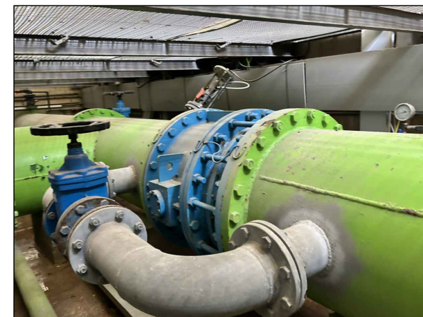
canonda sota tramex interior caseta d'entrada - sortida
