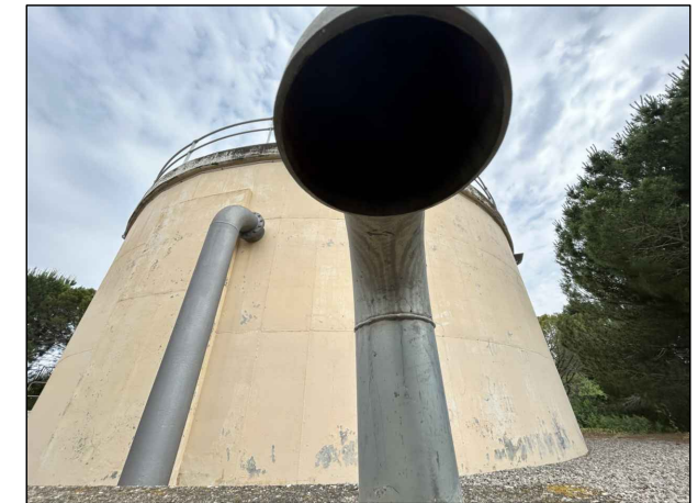
Manca de reixa en el sistema de ventilació
