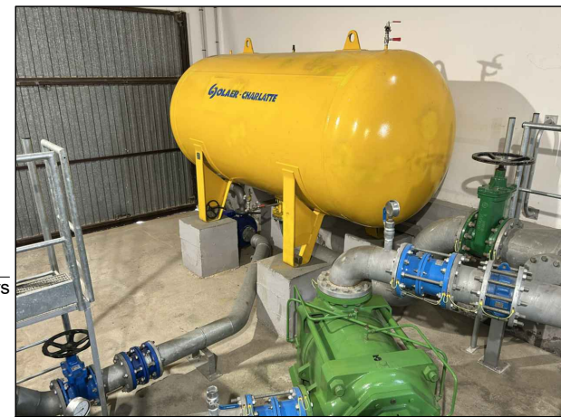
Calderi estació de bombament F6-02
