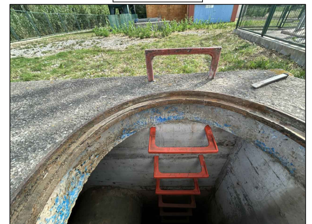
Interior arqueta G5-2E
