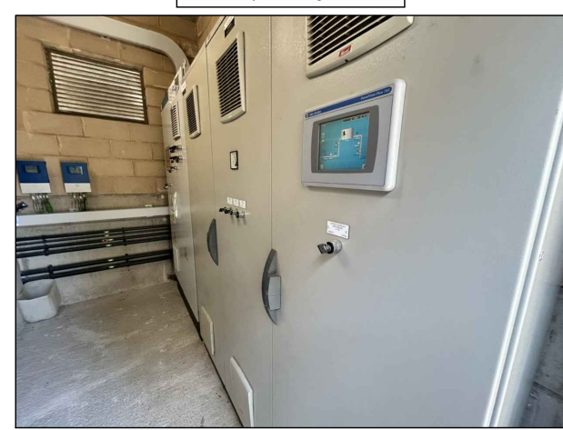
Interior sala elèctrica
