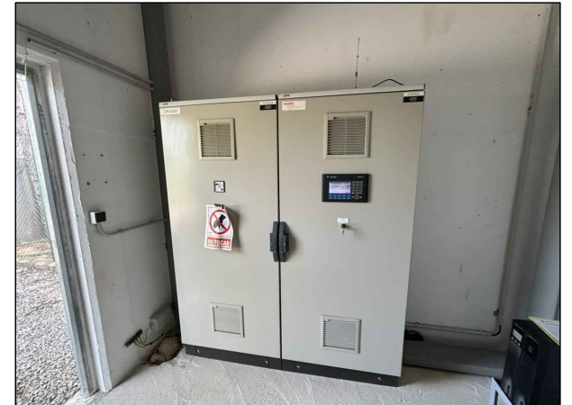
Interior sala elèctrica
