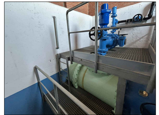
Interior caseta de derivació D2-31
