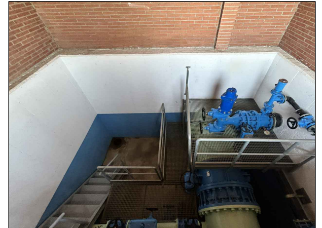
Interior caseta de derivació D2-31
