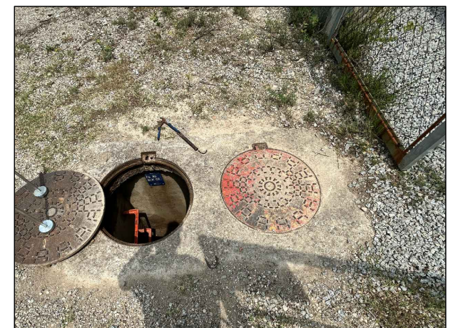
Arqueta hidrant E5-88
