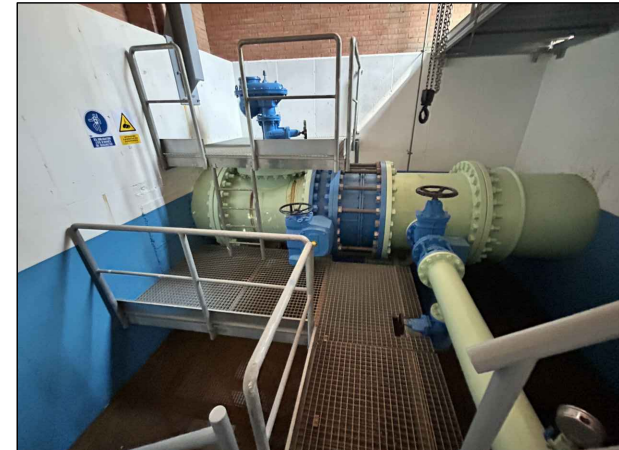
Interior caseta derivació
