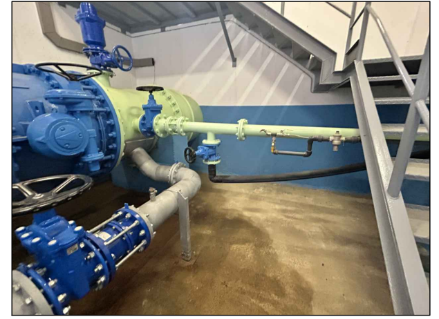
Interior caseta de derivació
