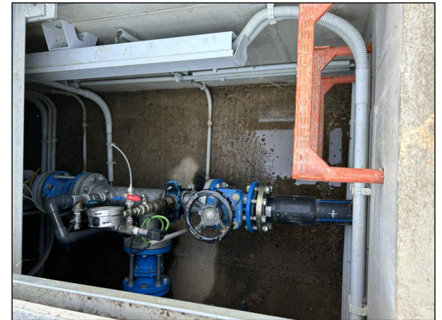
Accés arqueta C1-32
