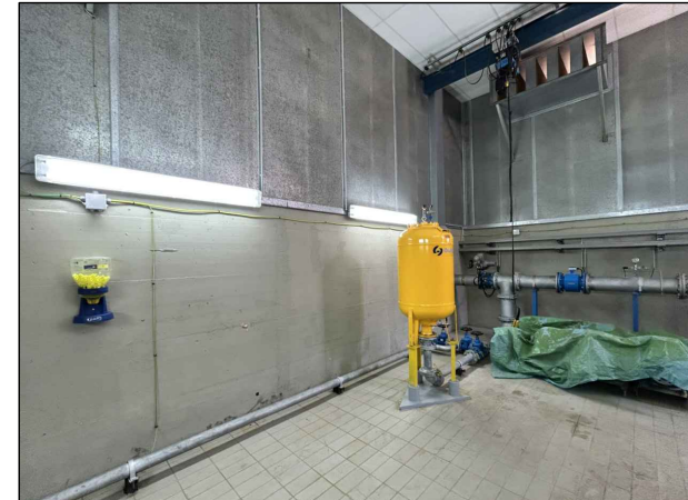
Interior de l'estació de bombament
