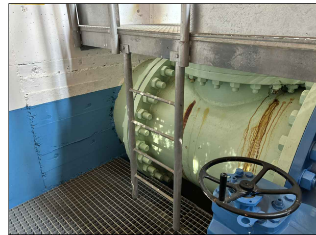
Interior caseta derivació
