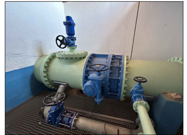
Manca de cartells de senyalització d'evacuació interior de la caseta
