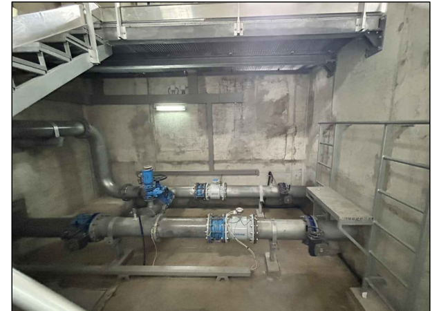
Interior caseta vàlvules
