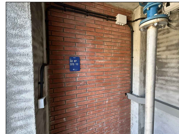
interior caseta obturador D2-87
