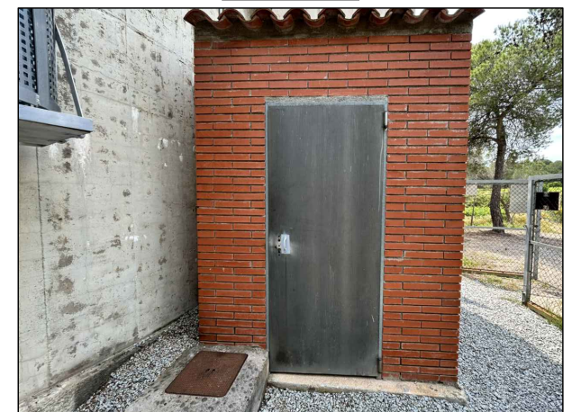
Caseta de comandament
