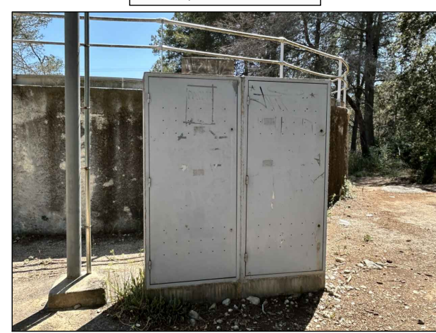
Armeni escomesa elèctrica
