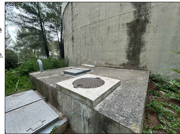
Arqueta entrada E6-51
