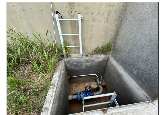
Interior arqueta E7-1C
