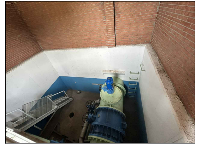
Interior caseta derivació E5-31
