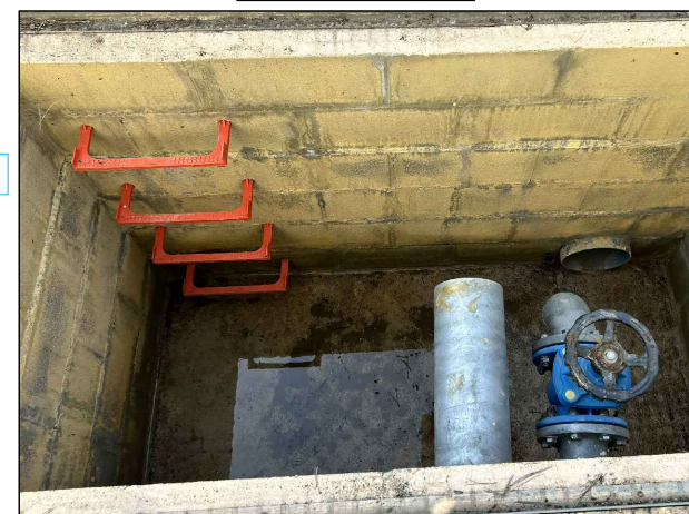
Interior arqueta desguàs C1-1E
