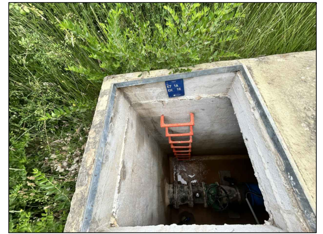
Exterior arqueta cabalímetre E7-1A
