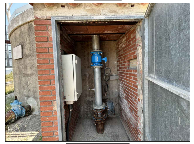
Interior caseta comptador
