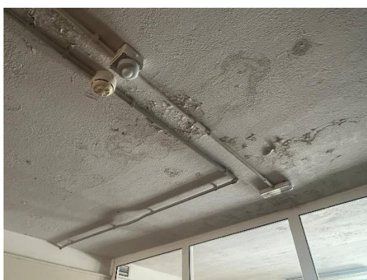
Vista de les patologies interiors derivades de les filtracions de la coberta
