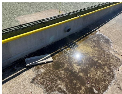
Vista de l'aigua embassada i dels baixants embussats que actualment hi ha al centre.
