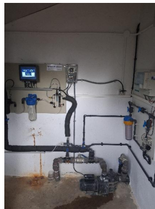
Figura 5. Telecontrol del dipòsit Nou.
