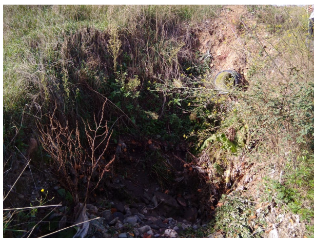
Figura 13 : Imatge de la sortida del sobreexidor d'aigües residuals
