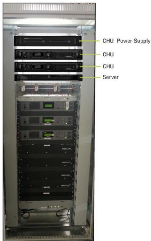
Figura 2. Estació Base Interior en armari
