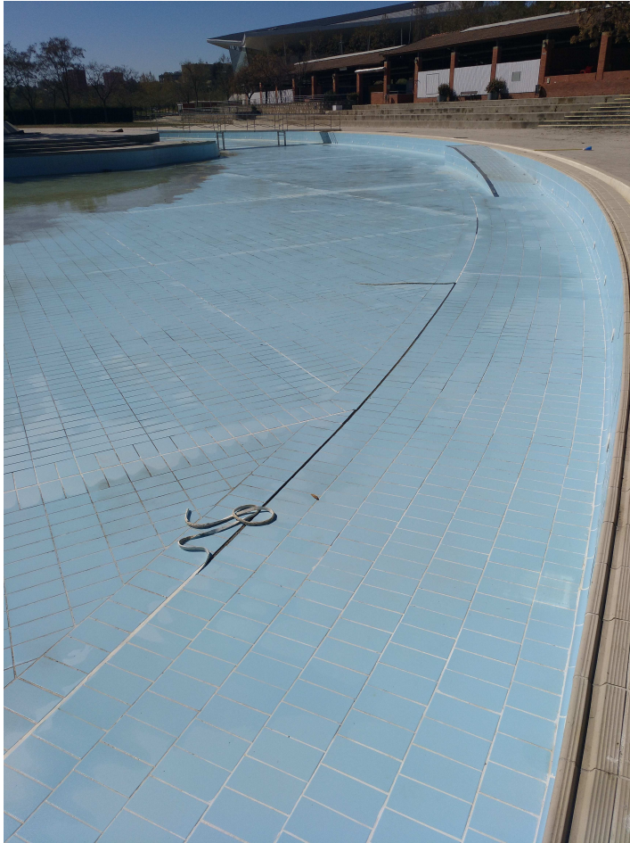
Cordó de segellat de junta de dilatació aixecat per l'ús
