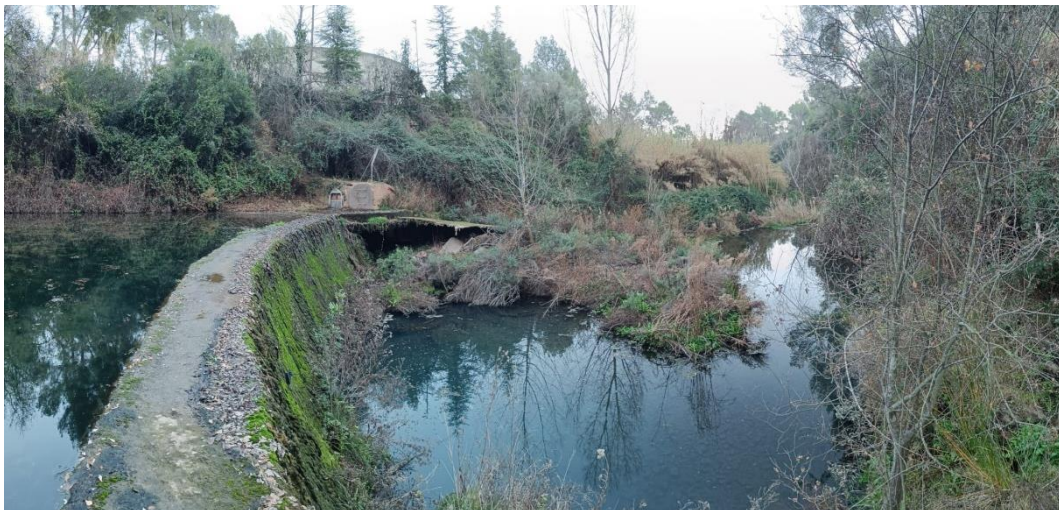
Figura 5 Resclosa de la font de la riera a l'inici de l'àmbit del projecte amb l'estructura de la rampa de peixos malmesa.
