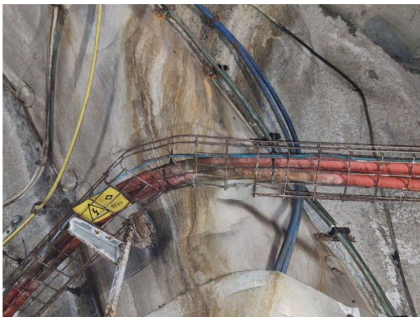
Suport oxidat, amb risc de trencar i caure a la via
