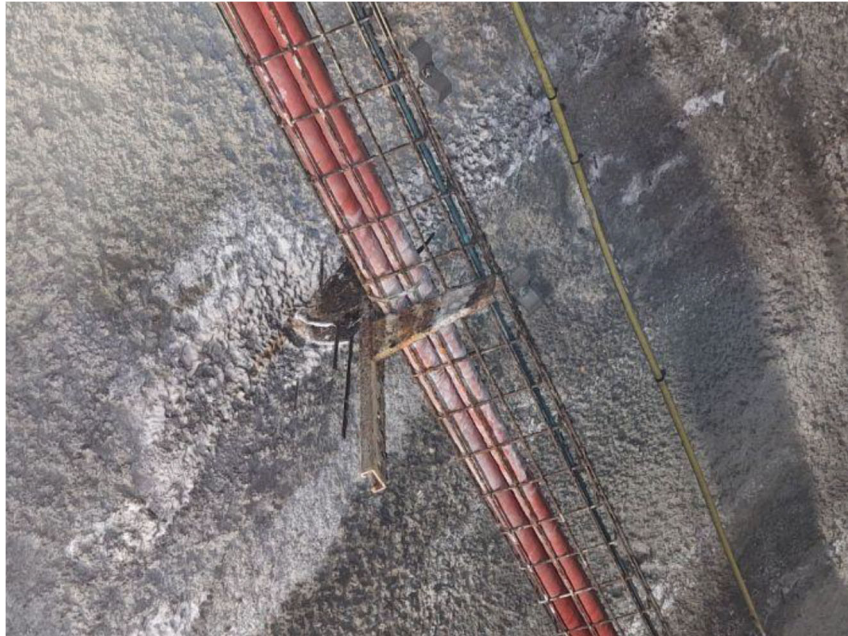
Suport oxidat i amb fixació malmesa, amb risc de caiguda a la via
