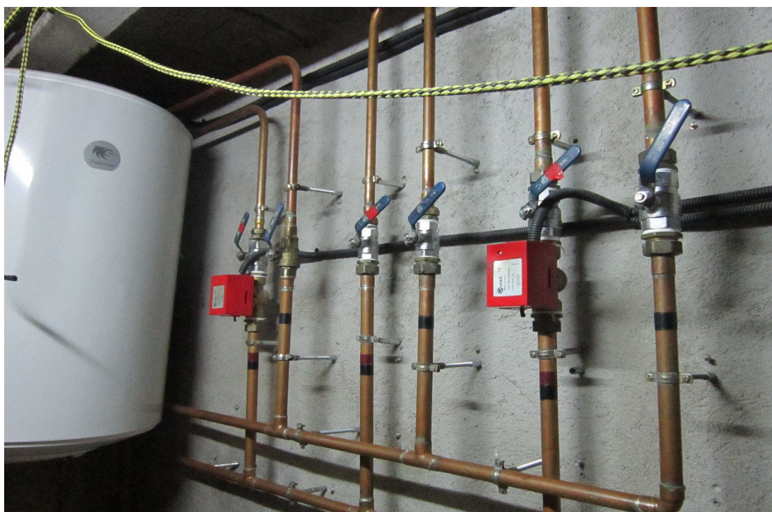
Imatge 04: Sala calderes actual
