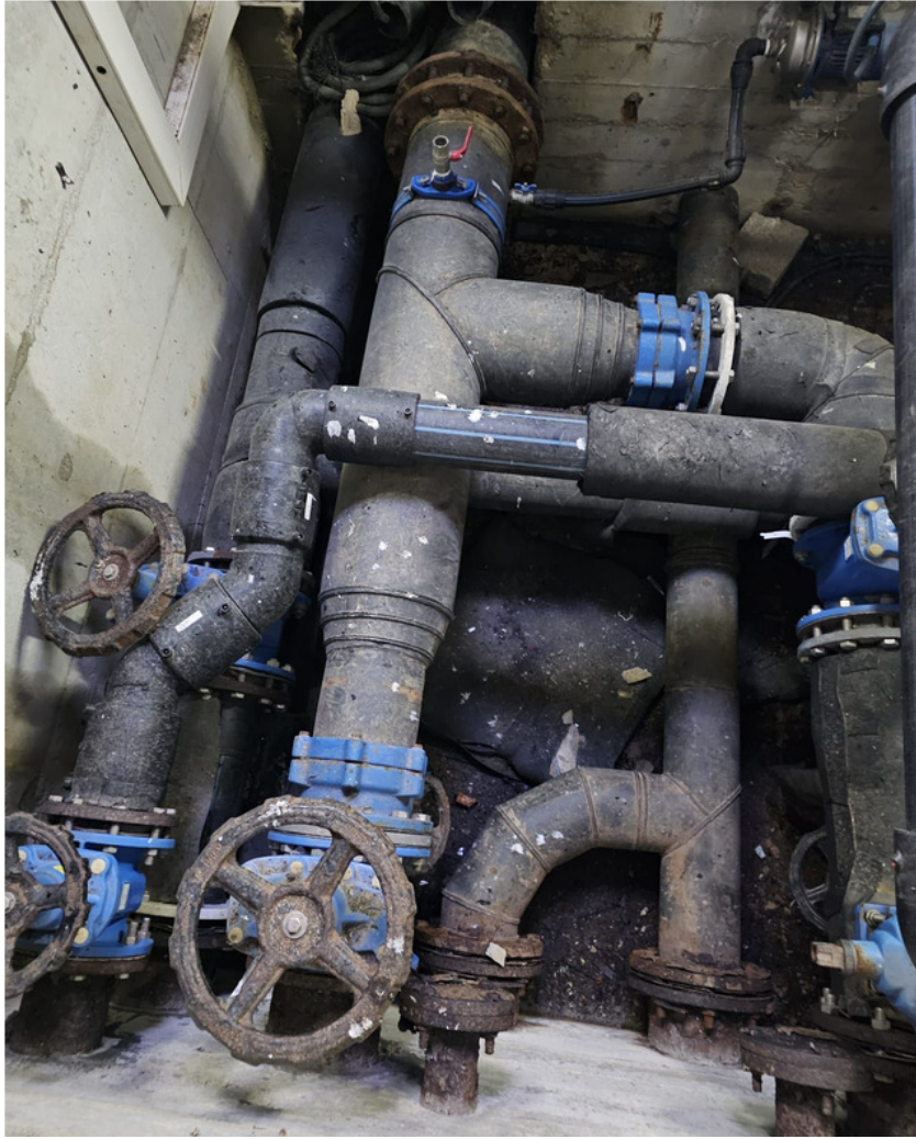
Canonada fundició DN300 sortida dipòsit cota 1.700
