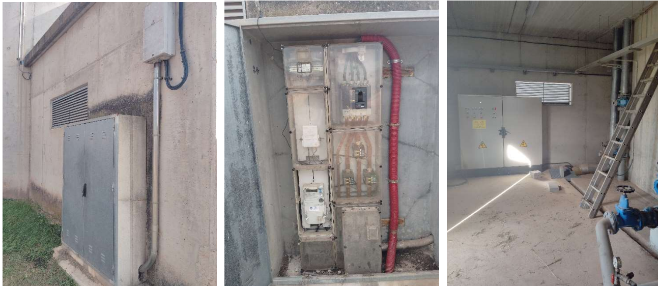
Figura 2.7. D'esquerra a dreta: TMF de consum existent i mur on anirà l'inversor i ubicació del QGBT.
