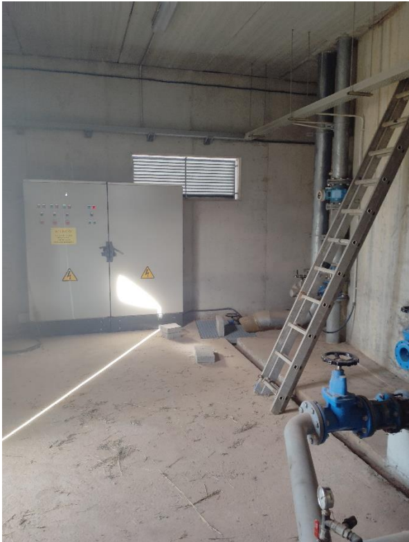
Figura 3. Vista interior de la caseta, mur on es col·locarà l'inversor.
