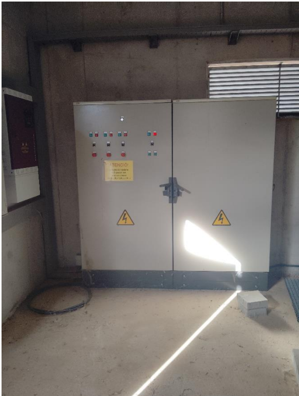
Figura 4. Quadre General de Baixa tensió on es connectarà la instal·lació FV.
