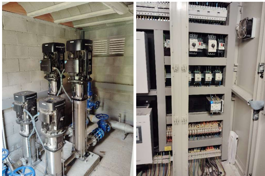
Figura 2.7. D'esquerra a dreta: paret on s'ubicarà l'inversor i QGBT on es realitzarà el punt de connexió.
