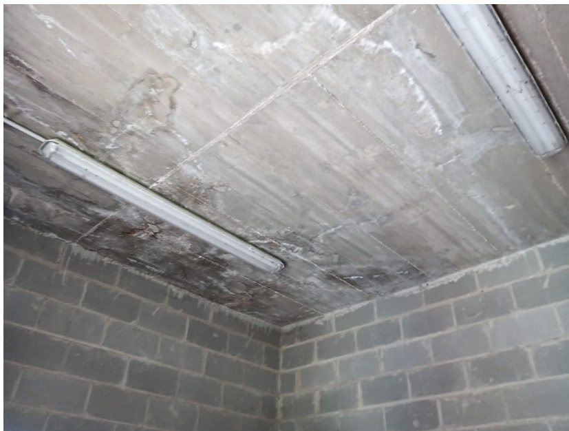
Llosa de coberta del recinte de bombament i restes de filtracions amb eflorescències d'aigua.
