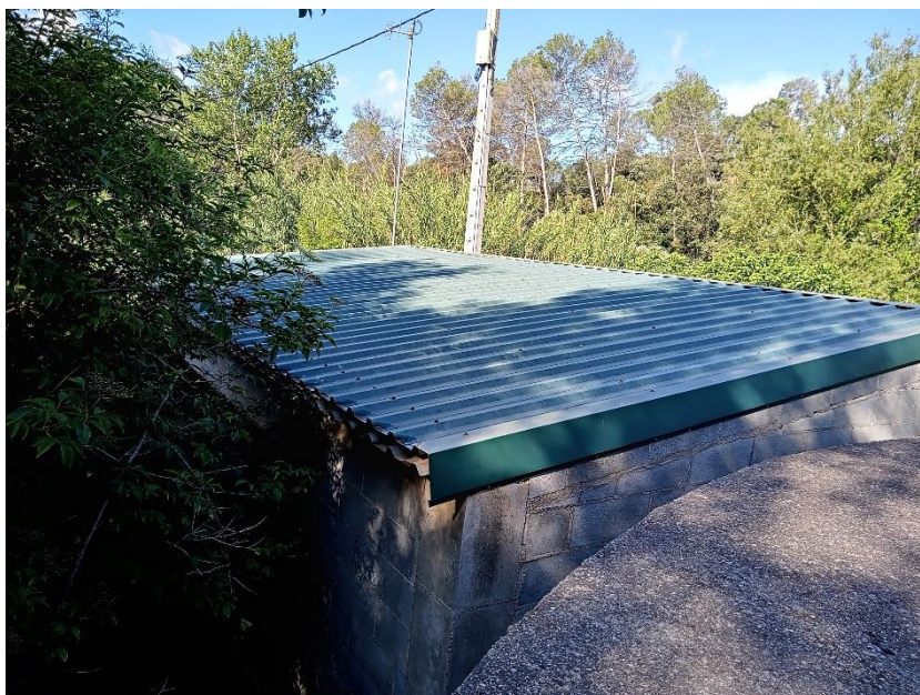
Coberta del recinte de bombament. Doble xapa en greca.
