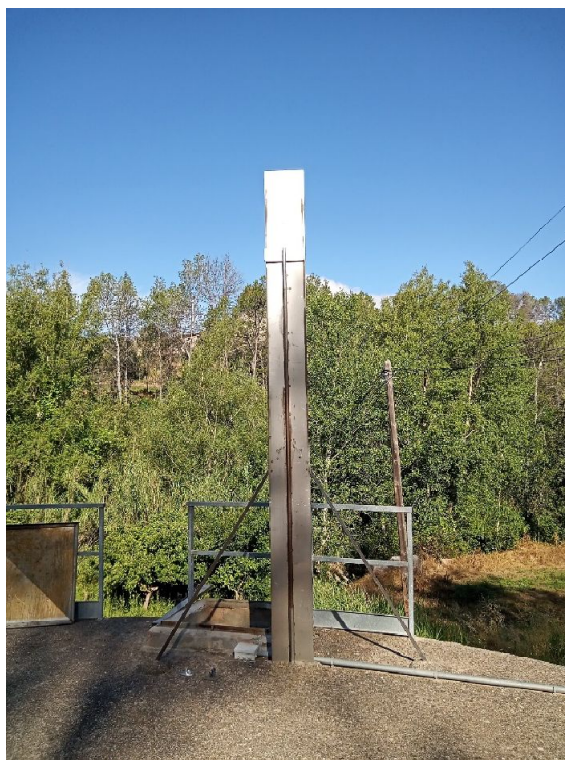
Sensor de nivell analògic sobre la coberta del dipòsit.
