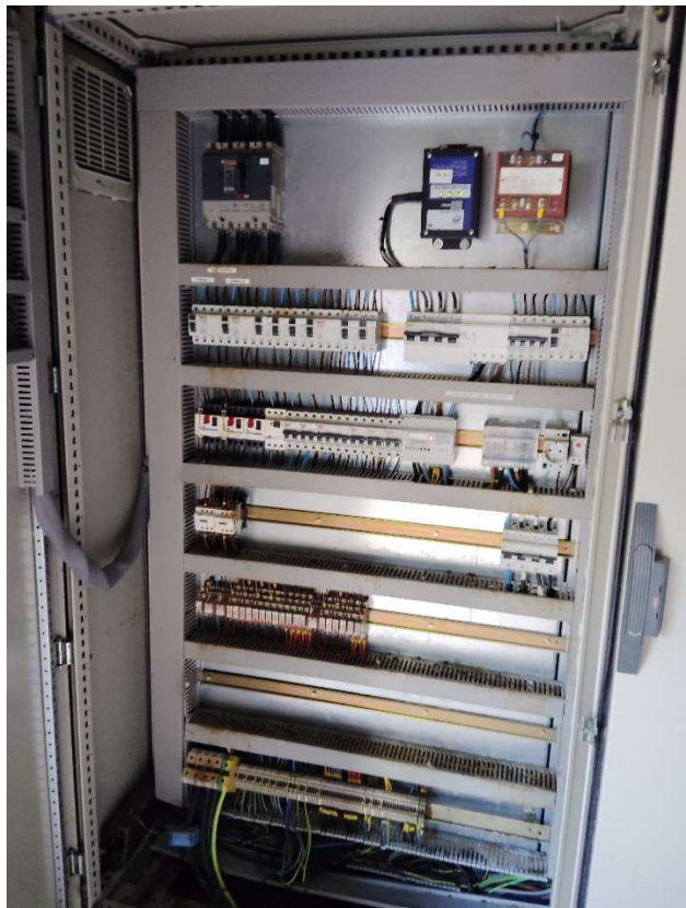
Figura 5. Interior del QGBT on s’instal·laran les proteccions de CA i es connectarà la instal·lació FV.
