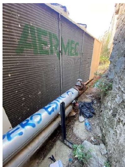
Instal.lació bomba calor existent
