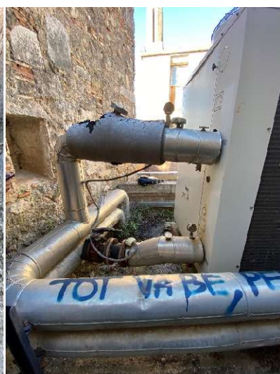
Instal.lació bomba calor existent
