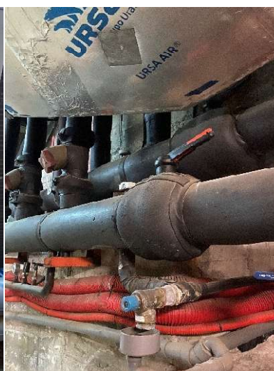
Sala màquines – Alimentació aigua
