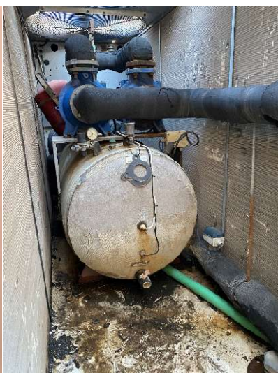
Interior bomba de calor
