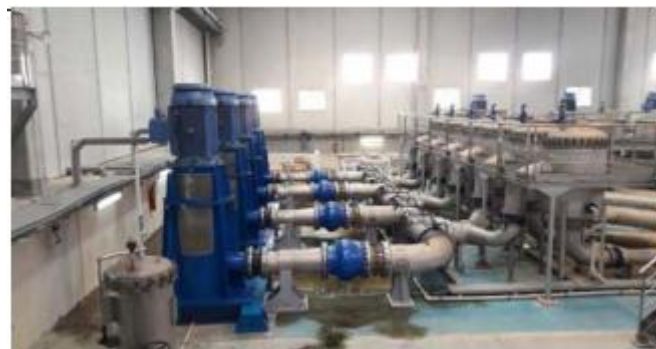
Imatge 4. Bombes i filtres de cartutx EDR actual
