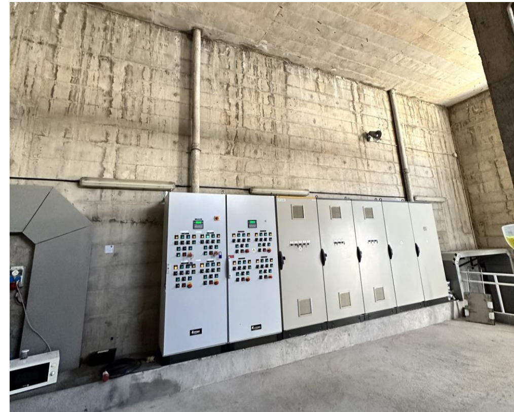
Imatge de l'interior de l'edifici de l'obra d'arribada on es troben els dos baixants
