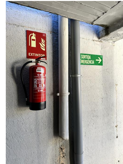
Imatge dels tres tubs de fibrociment a retirar
