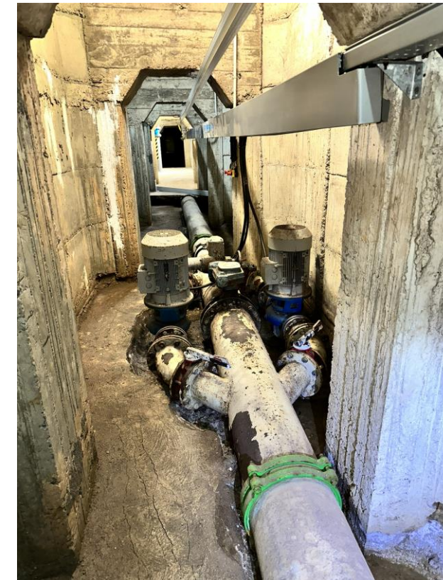
Bomba obsoleta a retirar
