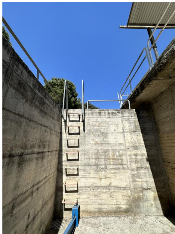
Vista de la zona exterior que comunica amb el passadís de les bateries
