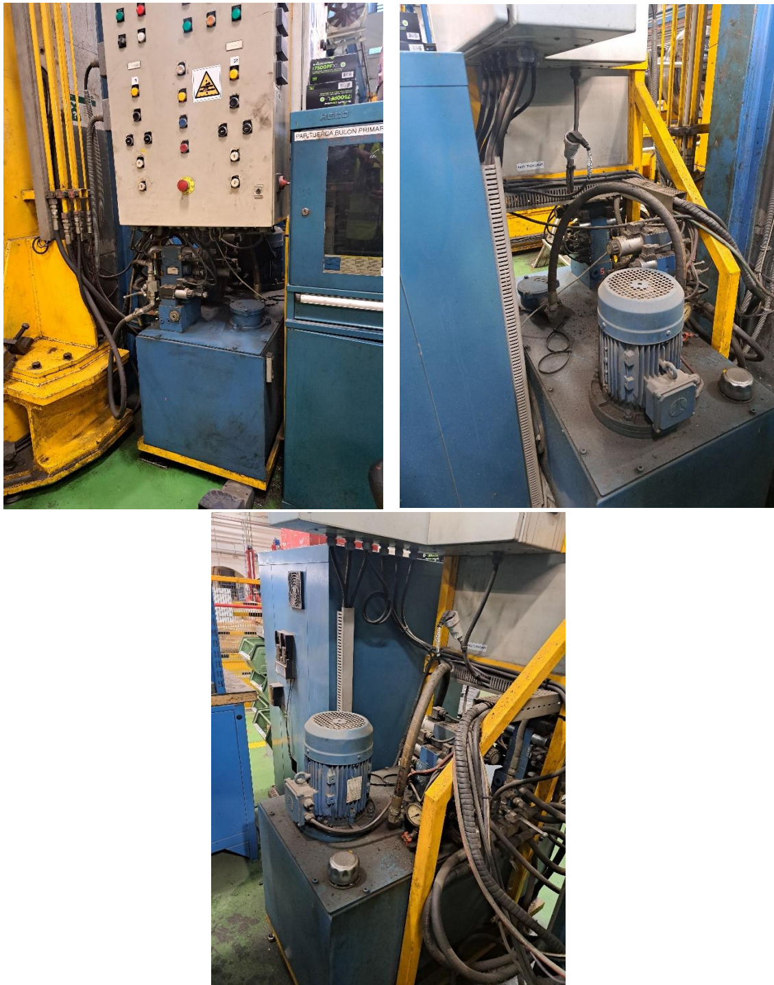
Fig. 6. Altres vistes de la unitat hidràulica.
