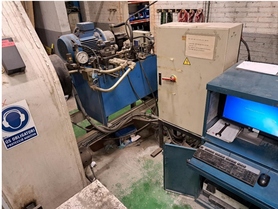
Fig. 2. Vista de la unitat hidràulica des del lloc d'operador.
