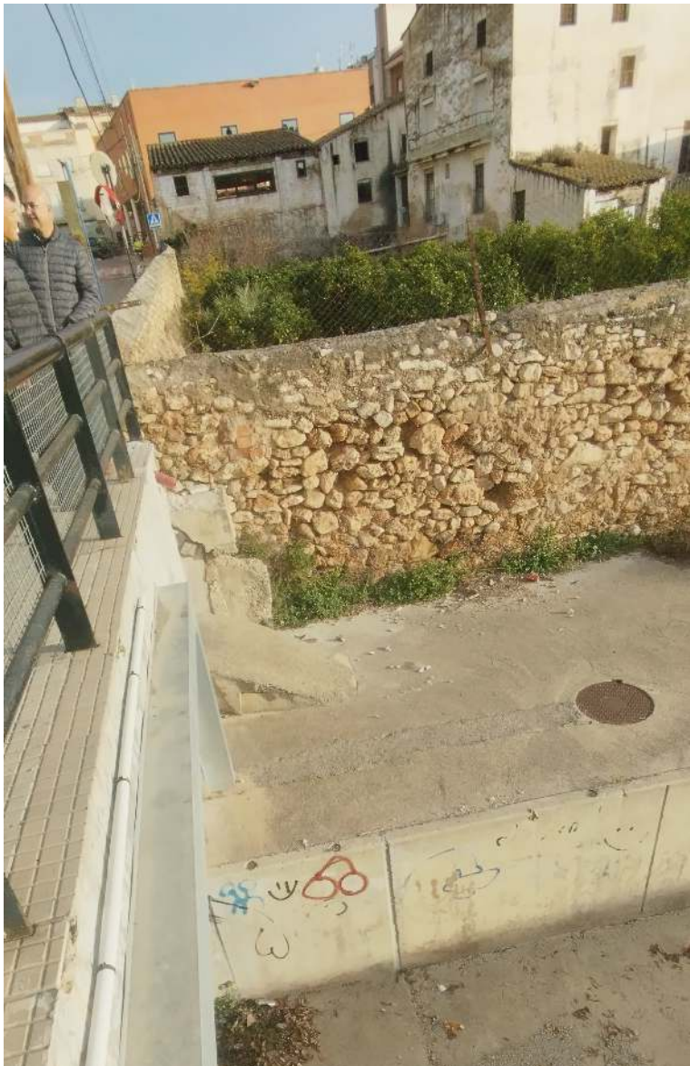
Punt d'abocament a la llera del barranc a l'alçada del pont de la carretera
