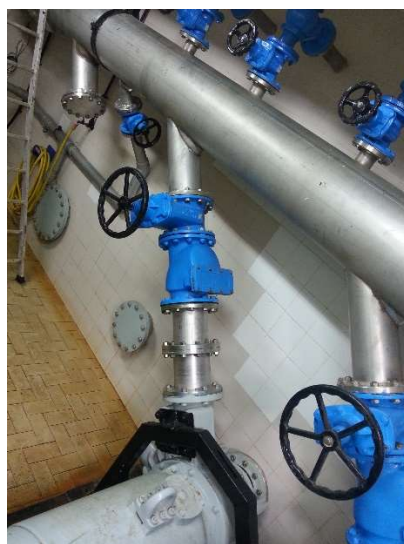
Figura 3. Caldereria, valvuleria i les bombes de cambra seca
