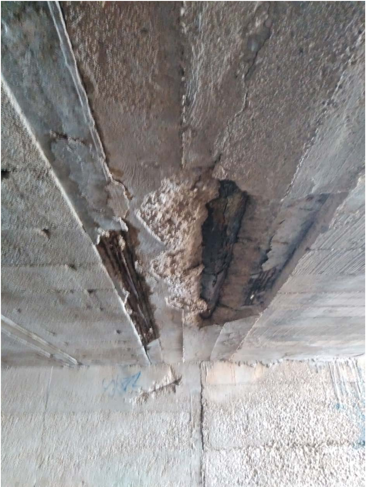
Fotografia 12. Detall de la transició de la llosa del marc al forjat unidireccional. No s'observa cap disposició ni junta especial. S'aprecia una canonada metàl·lica embeguda i totalment rovellada que ha fet malbé les dues biguetes adjacents, a banda de rebentar el formigó. També es veu la junta vertical del mur.
