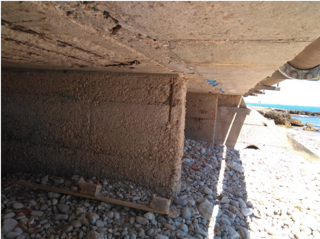
Fotografia 11. Desperfecte del mur central costat mar. Els còdols entren cap a dintre de l'endegament per les llevantades i evidentment castiguen el mur. També es pot observar una canonada de PVC blau embeguda a la llosa que marca el límit entre el marc i la biga-muret.
