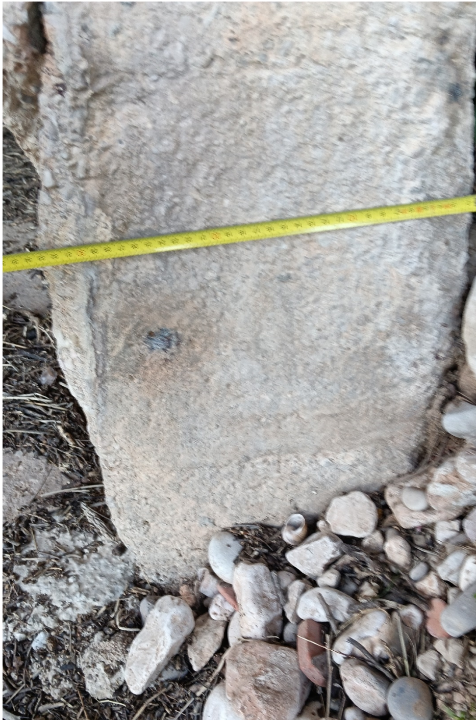
Fotografia 7. Aspecte i gruix del mur lateral, costat mar estrep nord. Presenta millor estat que el central, però també ha patit erosió.
