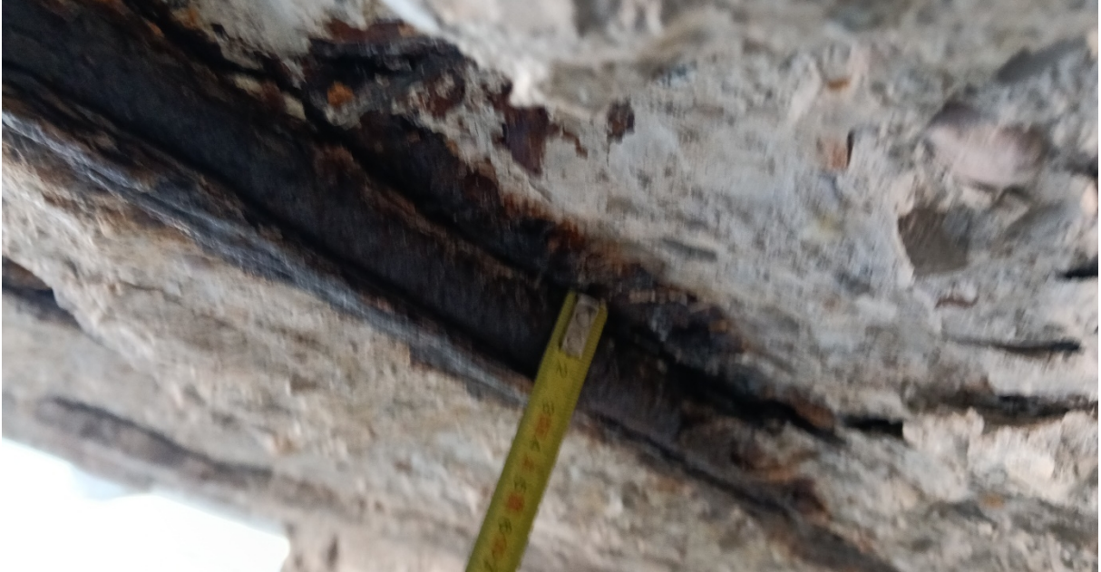
Fotografia 5. Diàmetre de la mateixa armadura (20mm).
