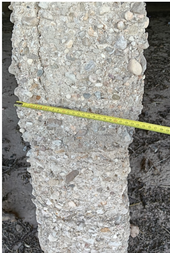
Fotografia 6. Aspecte i dimensions del mur central costat mar. Es pot apreciar el dany patit per l'erosió deguda als temporals marins.
