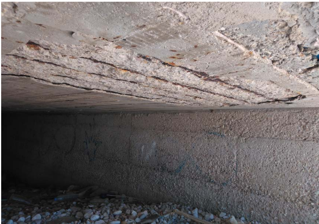
Fotografia 9. Desperfectes a la llosa de cobriment sota carrer Barcelona. També es pot apreciar el desgast per erosió dels murs.
