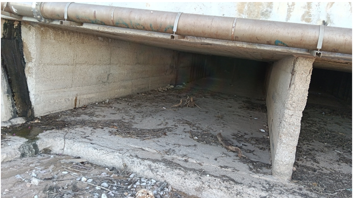
Fotografia 2. Ull dret del marc vist des d'aigües avall. Es pot veure la biga-muret i el seu recolzament sobre un estrep de formigó que no forma part del marc.
