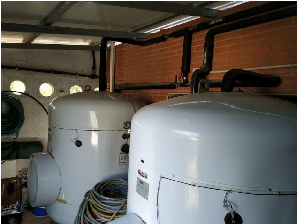
Imatge 5.- Dipòsits ACS d'acumulació solar situats a la sala dels dipòsits
