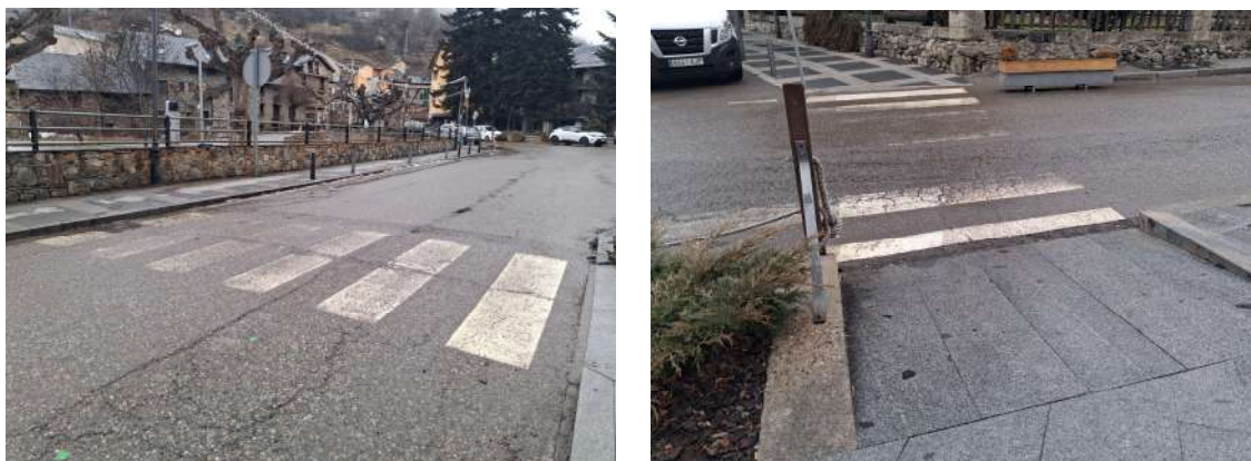
Imatge 3. Alguns dels passos de vianants es troben erosionats i no s'aprecien correctament. Tots ells manquen senyalització vertical.
